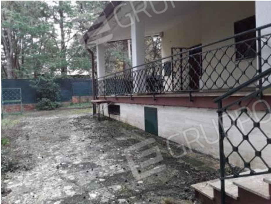
Foto n° 54 : locali tecnici sub 6-7
