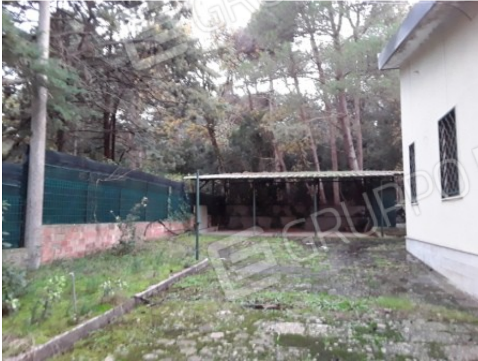
Foto n° 4 : lato ovest tettoia non conforme
