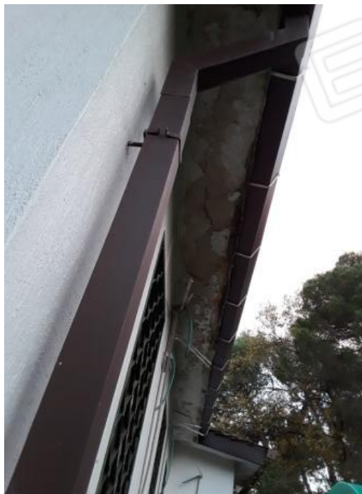
Foto n° 13 : rivestimento esterno deteriorato
