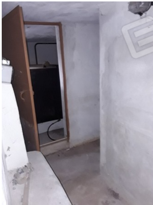
Foto n° 57 : vano caldaia sub 6
