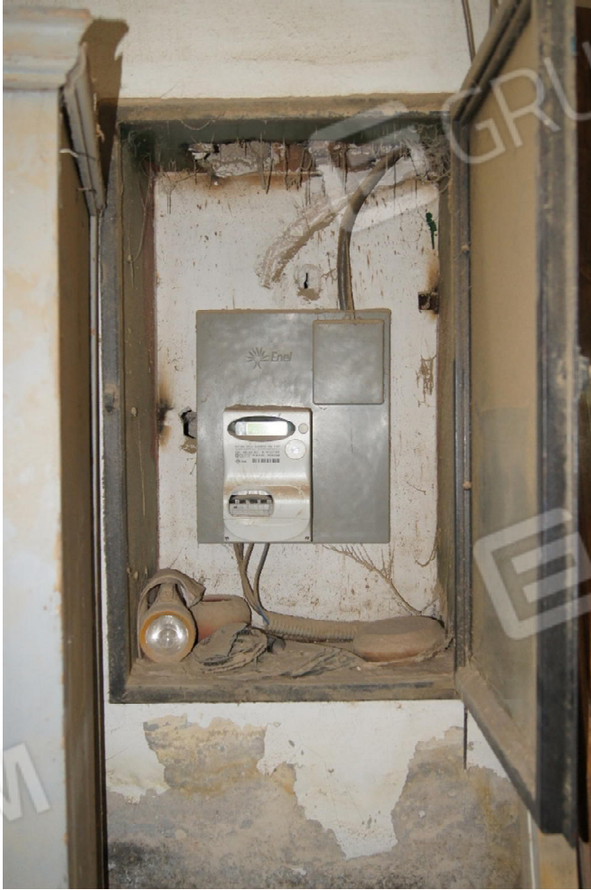
Foto 15: punto di consegna energia elettrica
