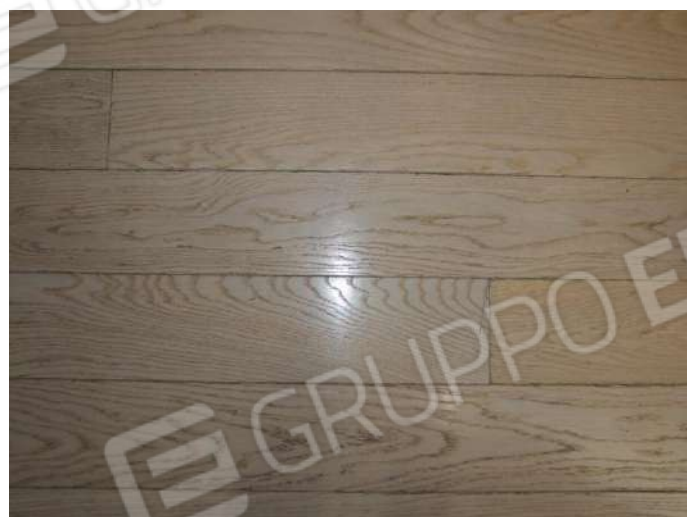
Foto 169 – Particolare pavimentazione zona notte.
