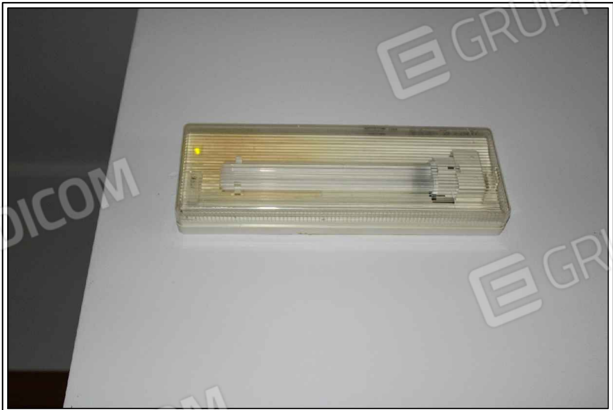
FOTO N° 66 - PARTICOLARE IMPIANTO LUCI D'EMERGENZA
