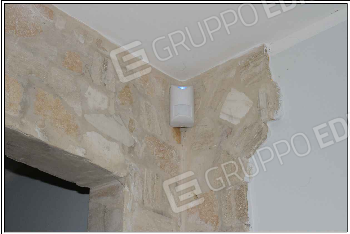
FOTO N° 65 - PARTICOLARE IMPIANTO ALLARME
