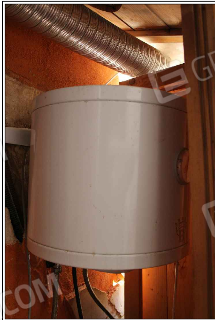
FOTO N° 74 - PARTICOLARE BOILER PRODUZIONE DI ACS
