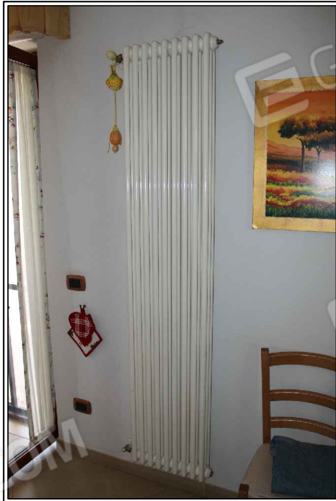
FOTO N° 70 - PARTICOLARE IMPIANTO DI RISCALDAMENTO
