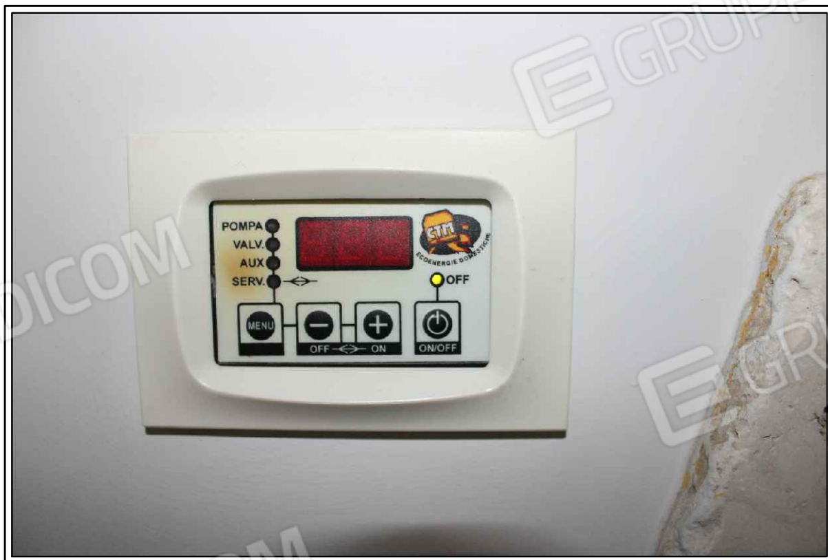
FOTO N° 68 - PARTICOLARE IMPIANTO TERMOCAMINO
