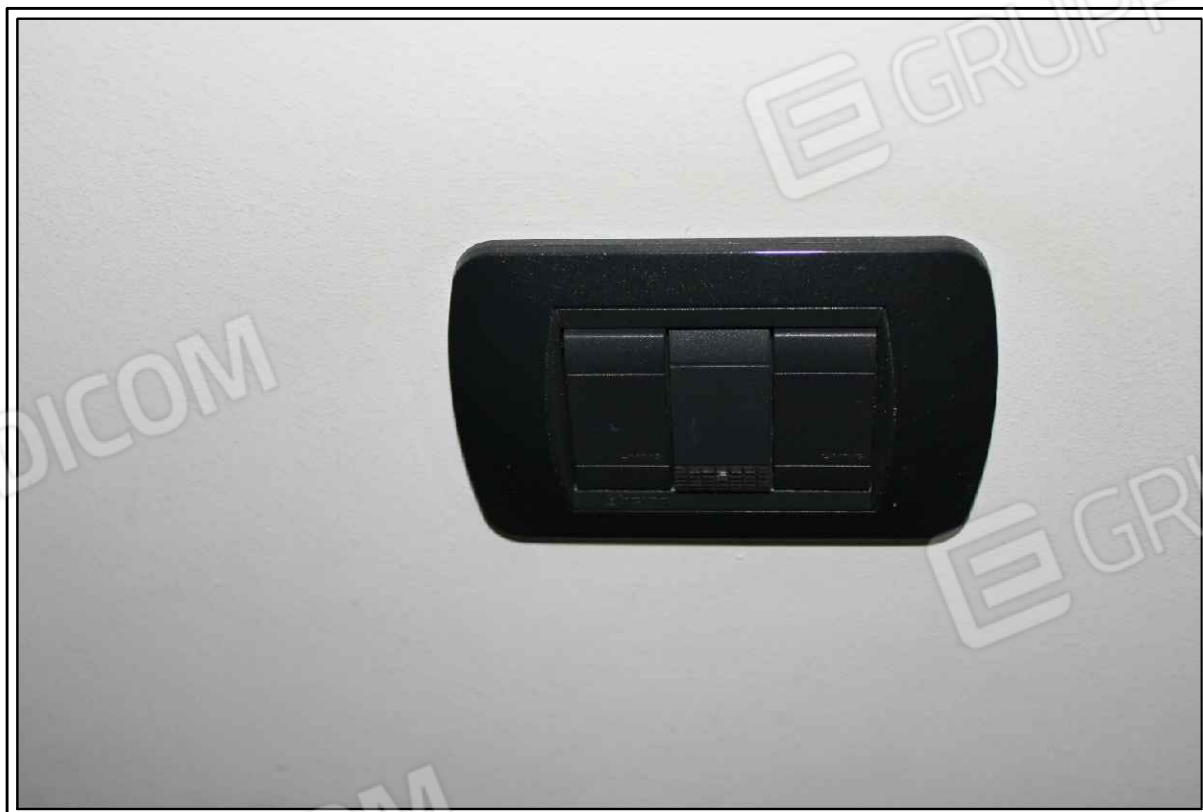
FOTO N° 62 - PARTICOLARE IMPIANTO ELETTRICO
