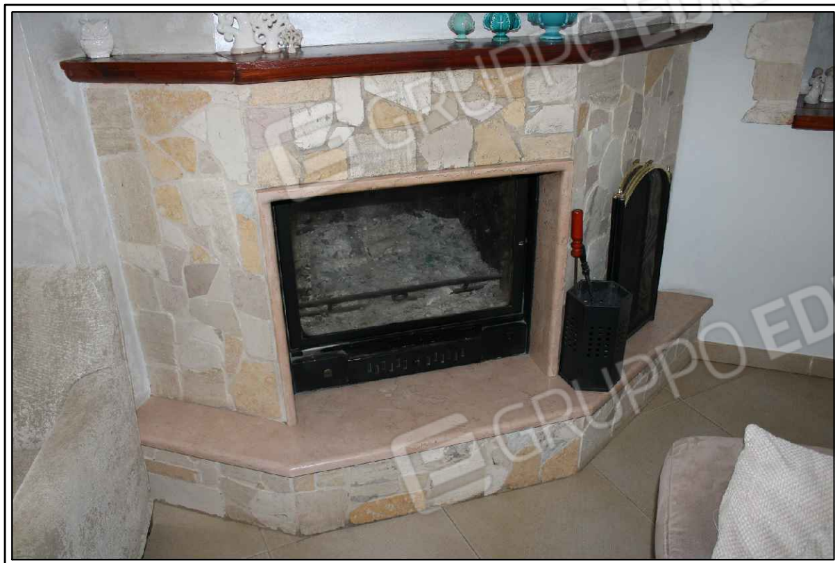
FOTO N° 67 - PARTICOLARE IMPIANTO DI RISCALDAMENTO (TERMOCAMINO)
