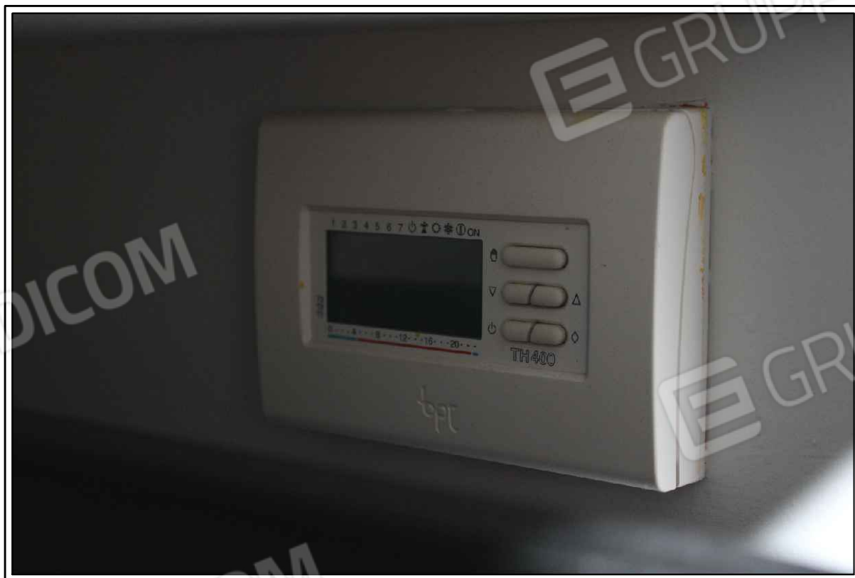
FOTO N° 72 - PARTICOLARE TERMOSTATO IMPIANTO DI RISCALDAMENTO
