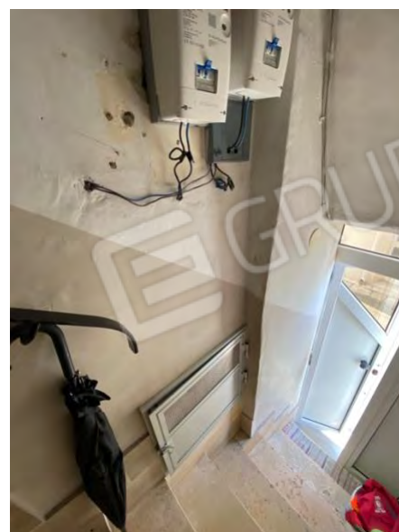
contatori impianto elettrico
