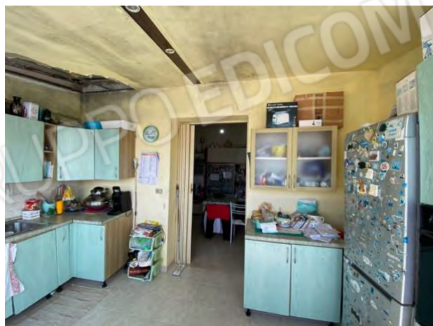
La cucina attuale in veranda non autorizzata verso il soggiorno, foto 1
