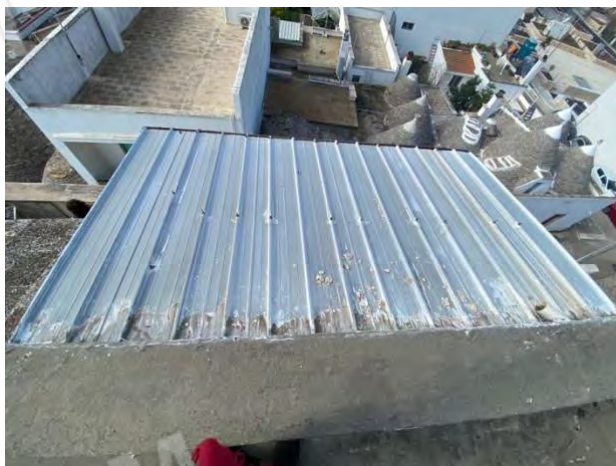
la copertura della veranda abusiva adibita a cucina raggiunta da Ordinanza di demolizione
