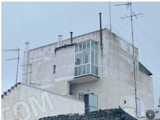
Dettaglio ripostiglio e veranda non autorizzata, visti dal retro; si nota il minore sviluppo in lunghezza del balcone rispetto a quanto previsto in progetto (lunghezza corrispondente a quanto riportato in planimetria catastale originaria)
