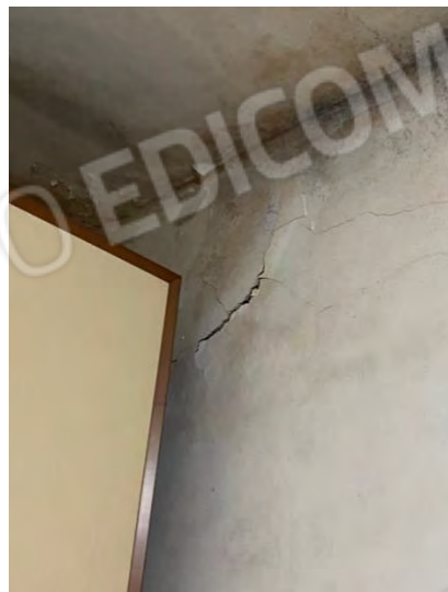
Camera matrimoniale, degrado per infiltrazioni – foto 1
