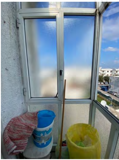
Veranda non autorizzata su balcone ex cucina – foto 1
