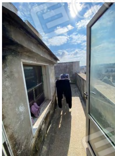
La portafinestra della veranda non autorizzata per l'accesso alla restante parte del terrazzo a livello su via Monte Grappa
