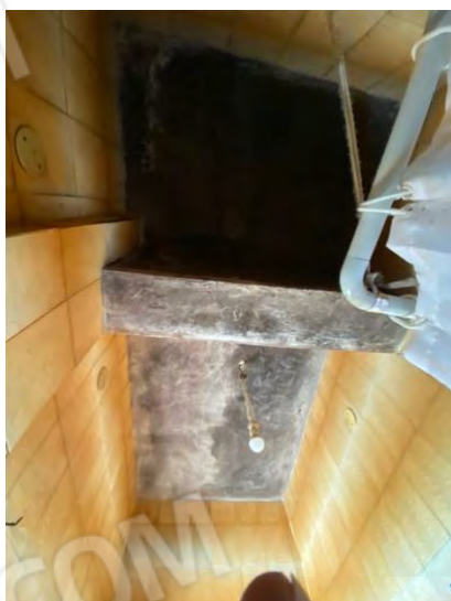
interno bagno, degrado solaio per infiltrazioni
