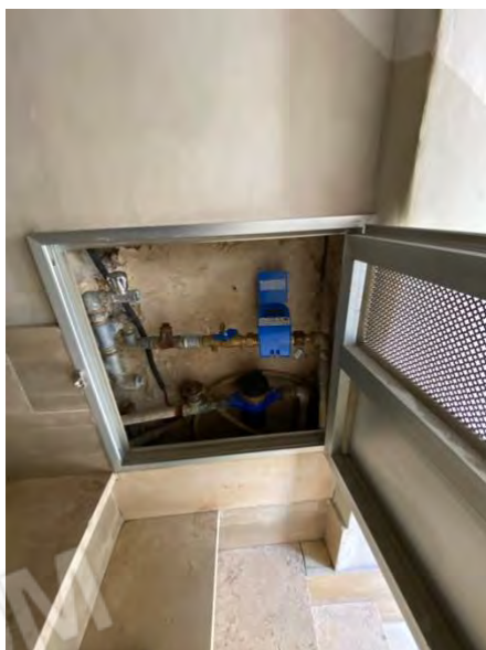
Contatori impianto idrico
