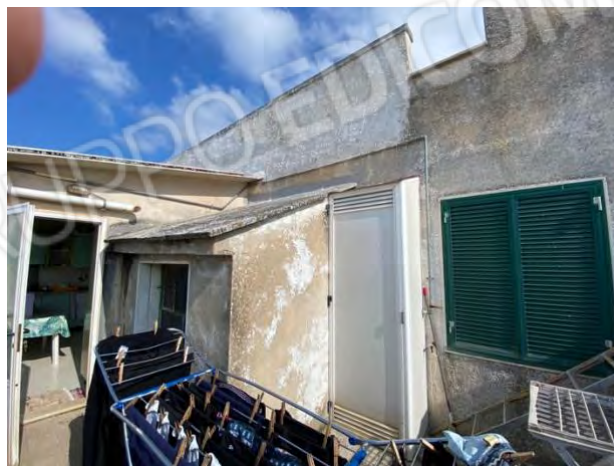
Terrazzo a livello restante - foto 2 con armadio in alluminio anodizzato preverniciato e pannelli in plastica per alloggiamento caldaia riscaldamento autonomo (non più funzionante)
