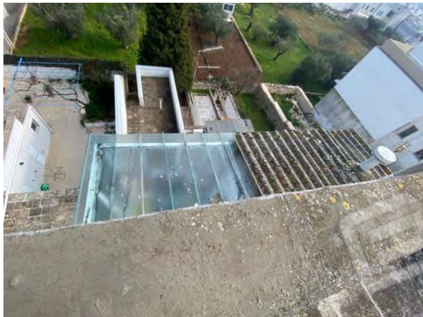
Copertura vetrata della veranda posteriore non autorizzata e copertura in lastre di fibrocemento (si ritiene con amianto) su travetti in legno del Ripostiglio, foto 1
