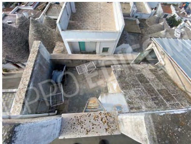
Il terrazzo a livello ora restante visto dal lastrico solare di proprietà esclusiva – si noti la copertura della veranda abusiva/cucina raggiunta da Ordinanza di demolizione
