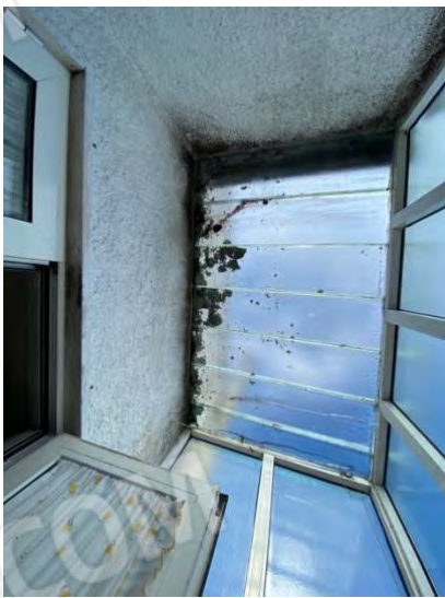
Veranda non autorizzata su balcone ex cucina, copertura in U-glas
