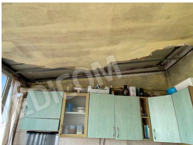
Condizioni di degrado della veranda non autorizzata raggiunta da Ordinanza di demolizione
