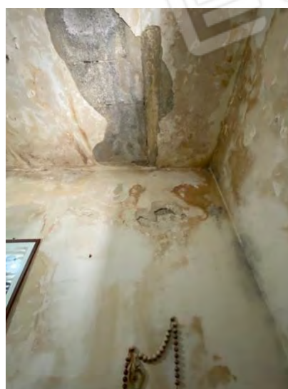
Camera matrimoniale, degrado per infiltrazioni – foto 5
