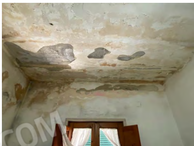
Camera matrimoniale, degrado per infiltrazioni – foto 2
