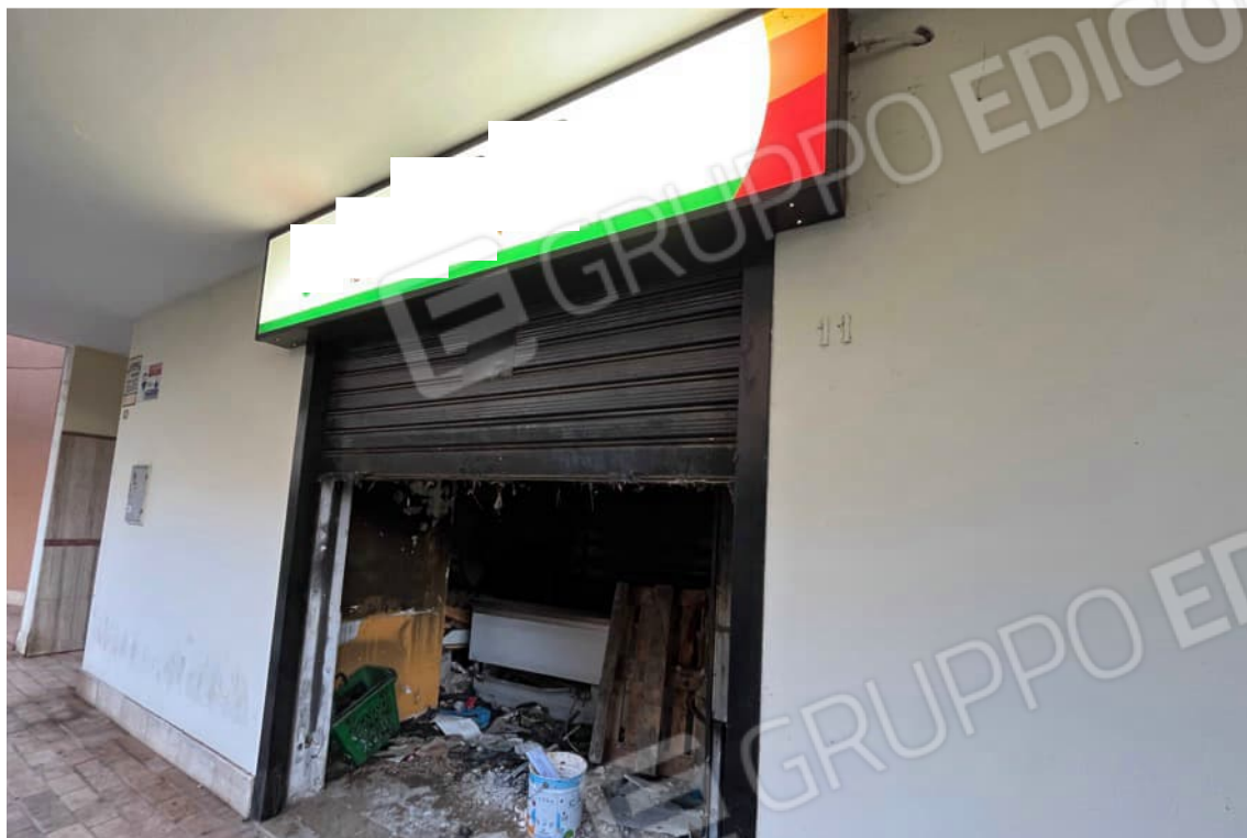
Fig.13 – Vista di parte del sub.28 danneggiato dal fuoco e posto al civ. 11
