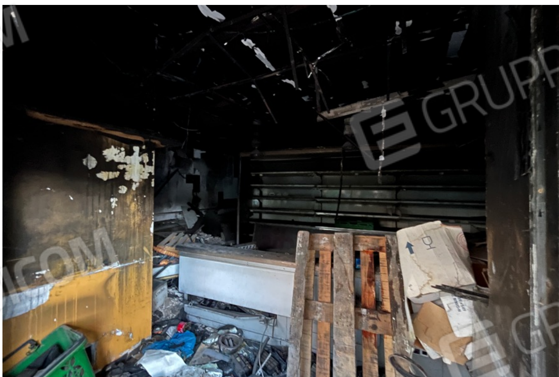
Fig.14 – Vista di parte del sub.28 danneggiato dal fuoco e posto al civ.11
