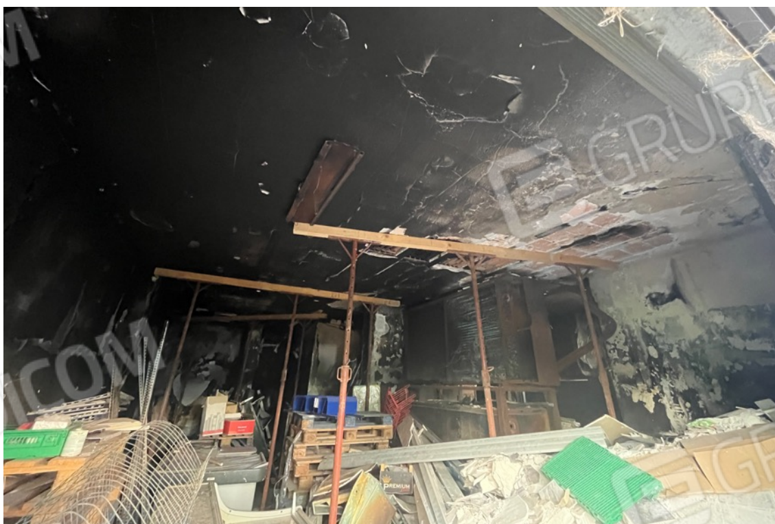
Fig.5– Vista all'interno della proprietà danneggiata dall'incendio
