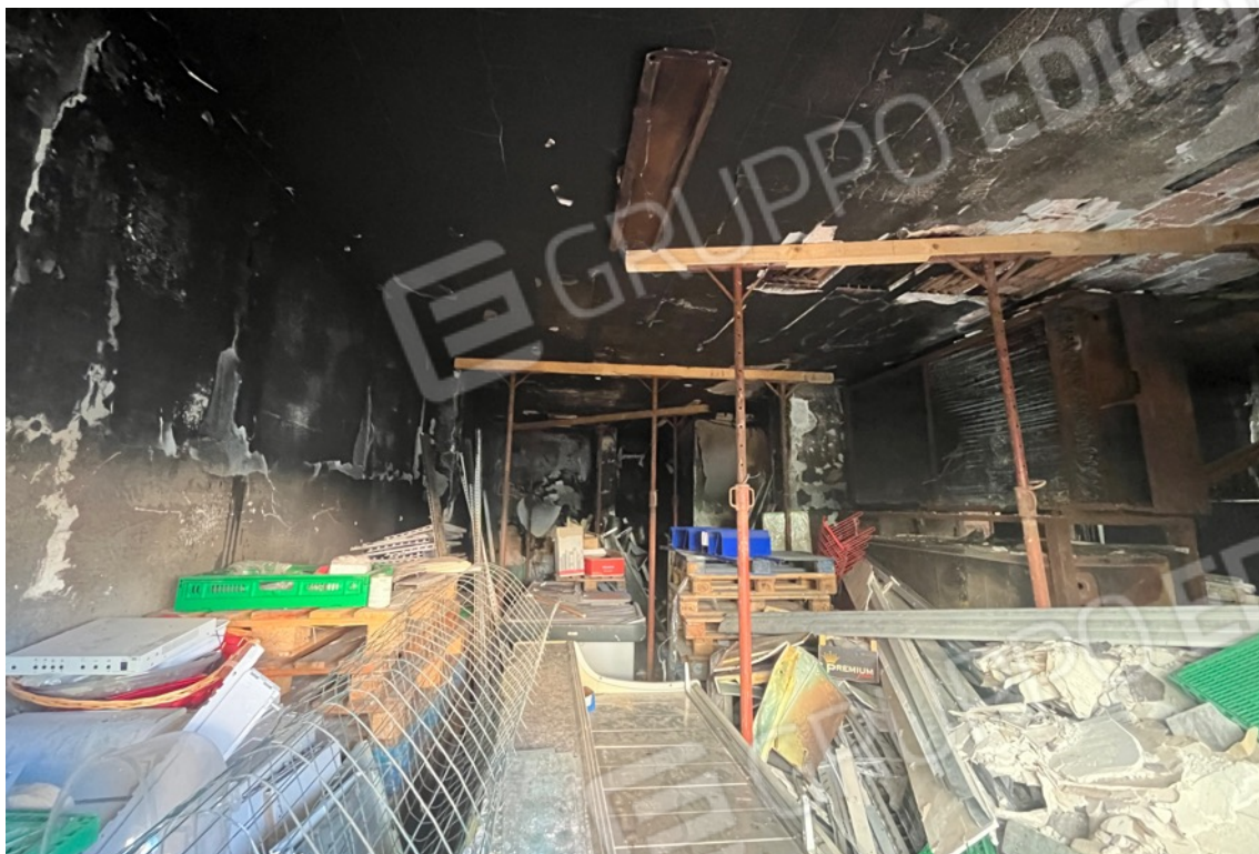
Fig.6– Vista all'interno della proprietà danneggiata dall'incendio
