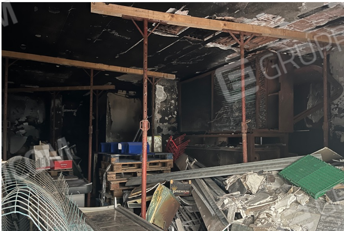
Fig.7 – Vista interna del locale percorso dai danni da incendio
