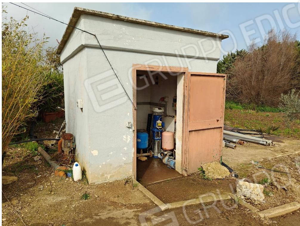
Immagine 5: Locale pompe per pozzo e irrigazione
