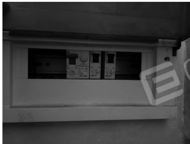
Figura 15: quadro elettrico generale (unico quadro dell'abitazione)
