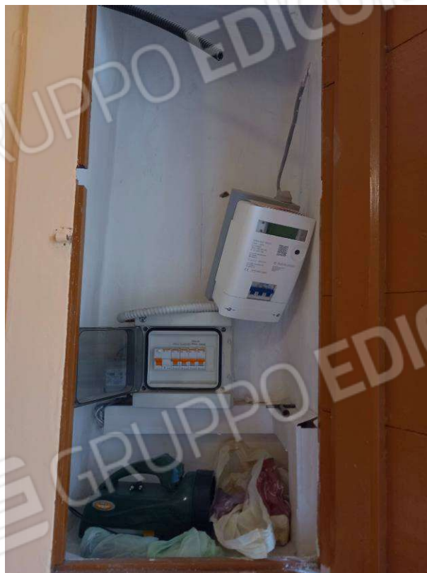
FOTO 31: particolare quadro elettrico
