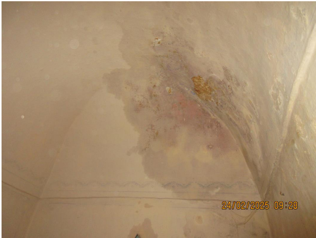
Foto n.25 Evidenti tracce di fenomeni di infiltrazioni delle acque meteoriche
