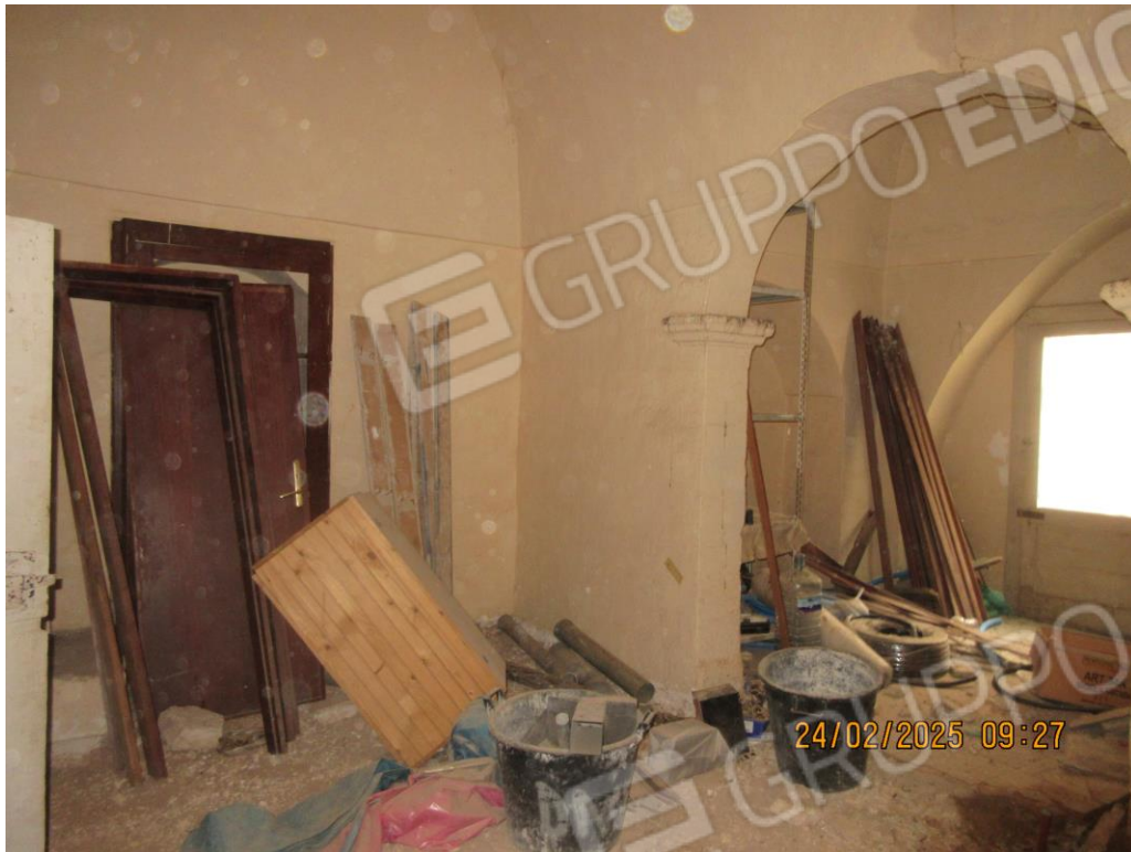
Foto n.23 ambiente n.7 in scadenti condizioni
