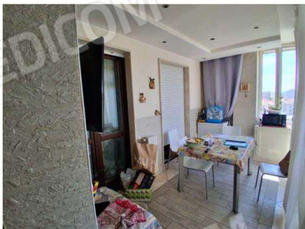
Vista interna Balcone (la chiusura a vetri abusiva è da rimuovere)
