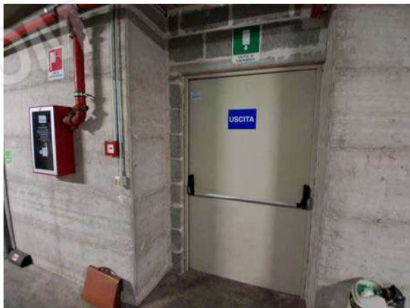
Vista della porta tagliafuoco di accesso al piano dei Box
