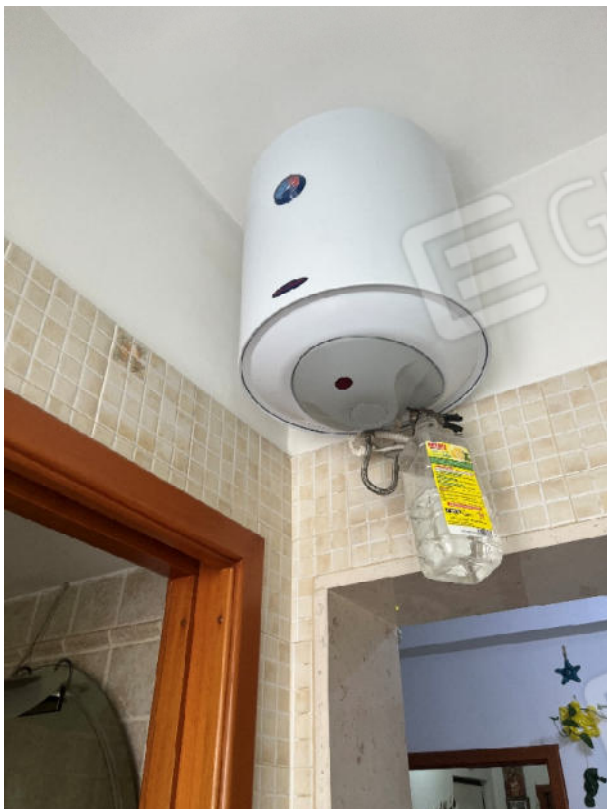
Boiler elettrico installato nel cucinino
