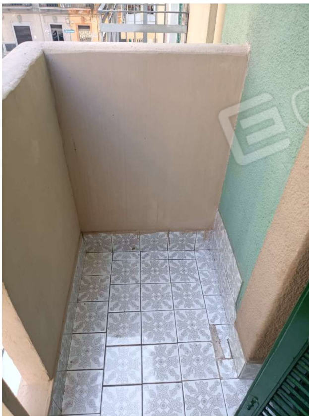
Foto 12 – Balcone prospiciente su via Bavaro
