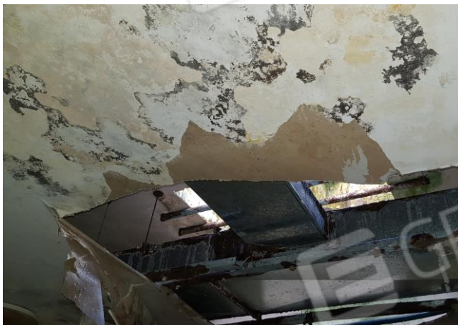
7. Stato di conservazione dei controsoffitti
