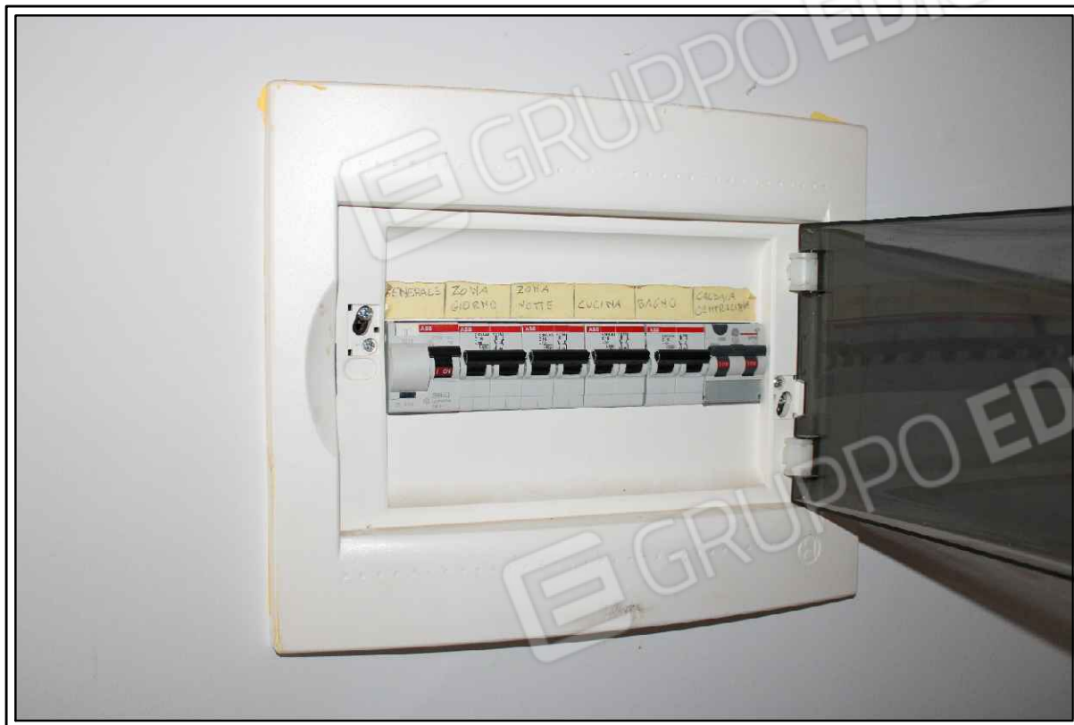
FOTO N° 61 - PARTICOLARE IMPIANTO ELETTRICO
