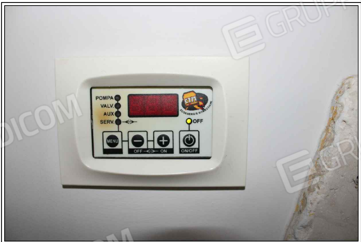
FOTO N° 68 - PARTICOLARE IMPIANTO TERMOCAMINO
