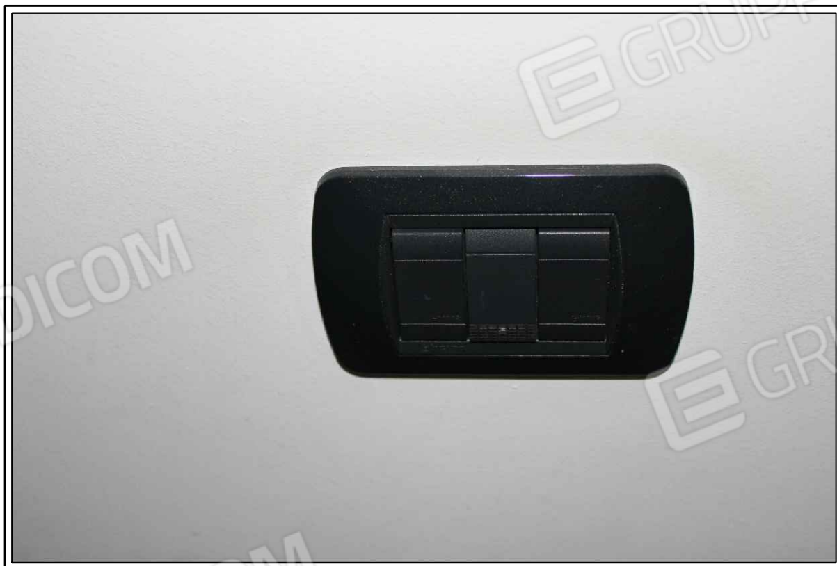
FOTO N° 62 - PARTICOLARE IMPIANTO ELETTRICO
