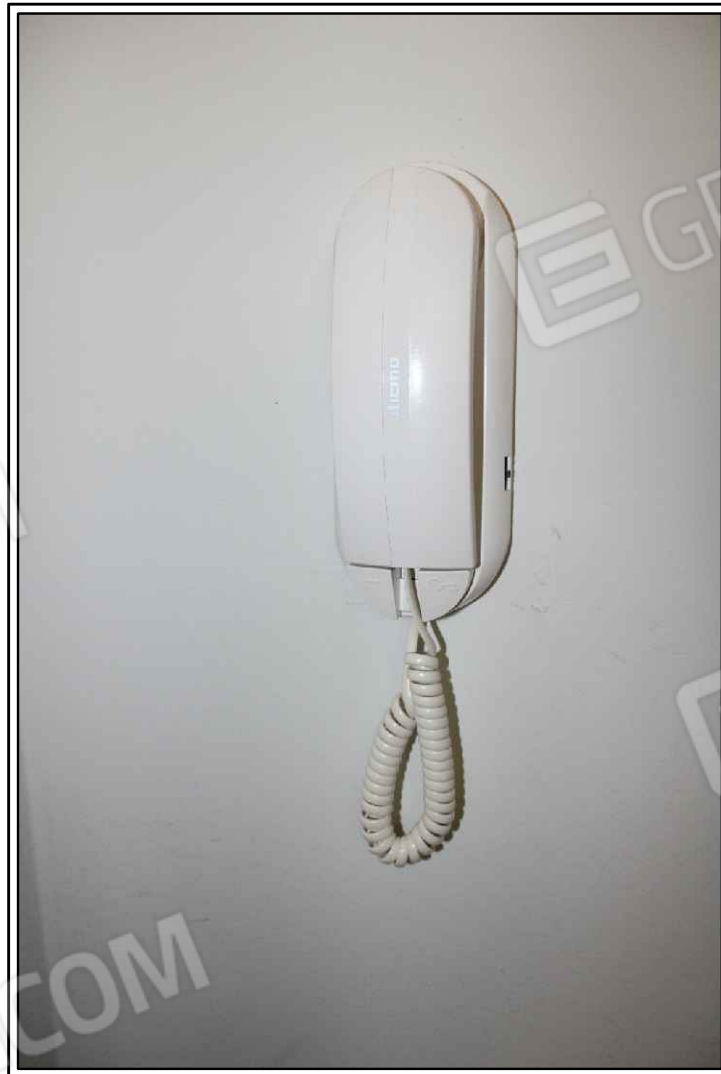
FOTO N° 64 - PARTICOLARE IMPIANTO CITOFONICO
