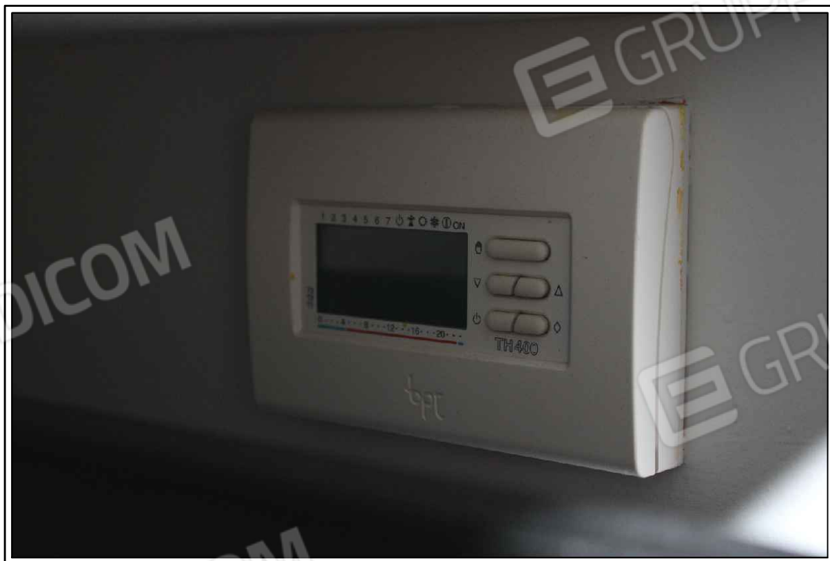
FOTO N° 72 - PARTICOLARE TERMOSTATO IMPIANTO DI RISCALDAMENTO
