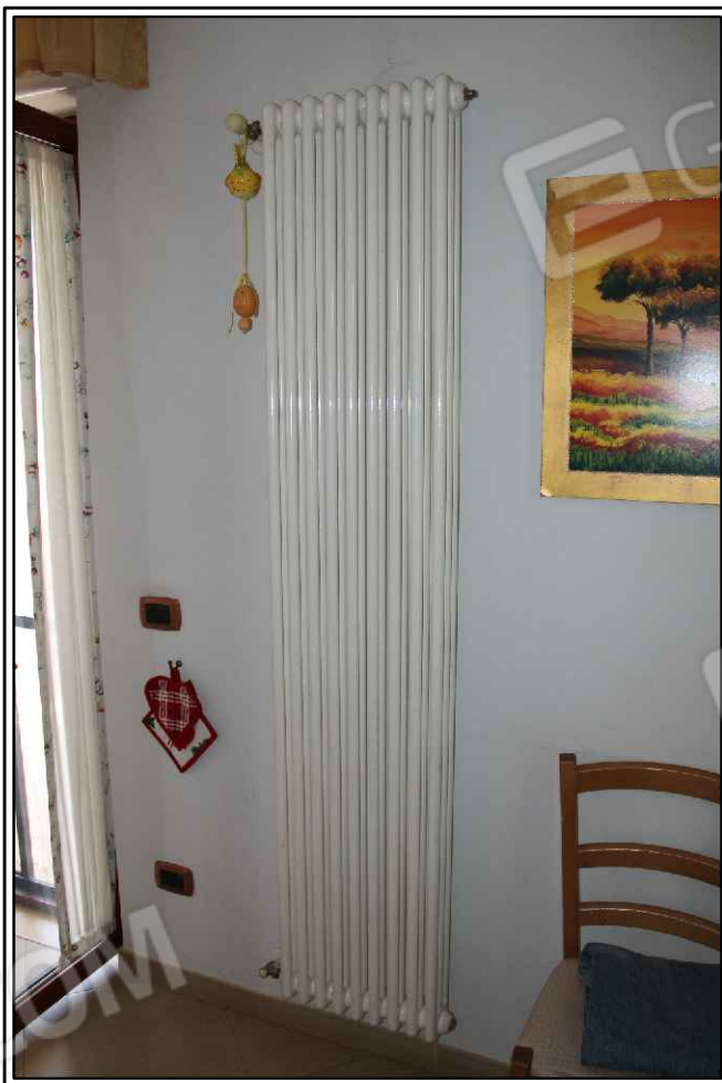
FOTO N° 70 - PARTICOLARE IMPIANTO DI RISCALDAMENTO
