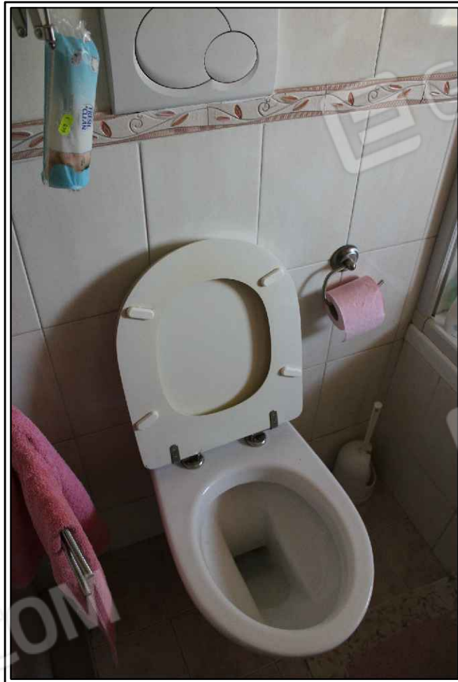
FOTO N° 58 - PARTICOLARE SANITARI W.C. 1
