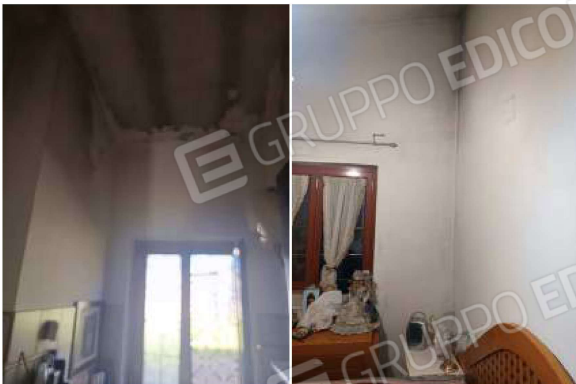
Foto 23, 24 – fenomeni di condensa in vari punti dell'alloggio
