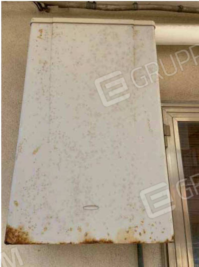
Foto 16) – Caldaia (IMMOBILE A)
