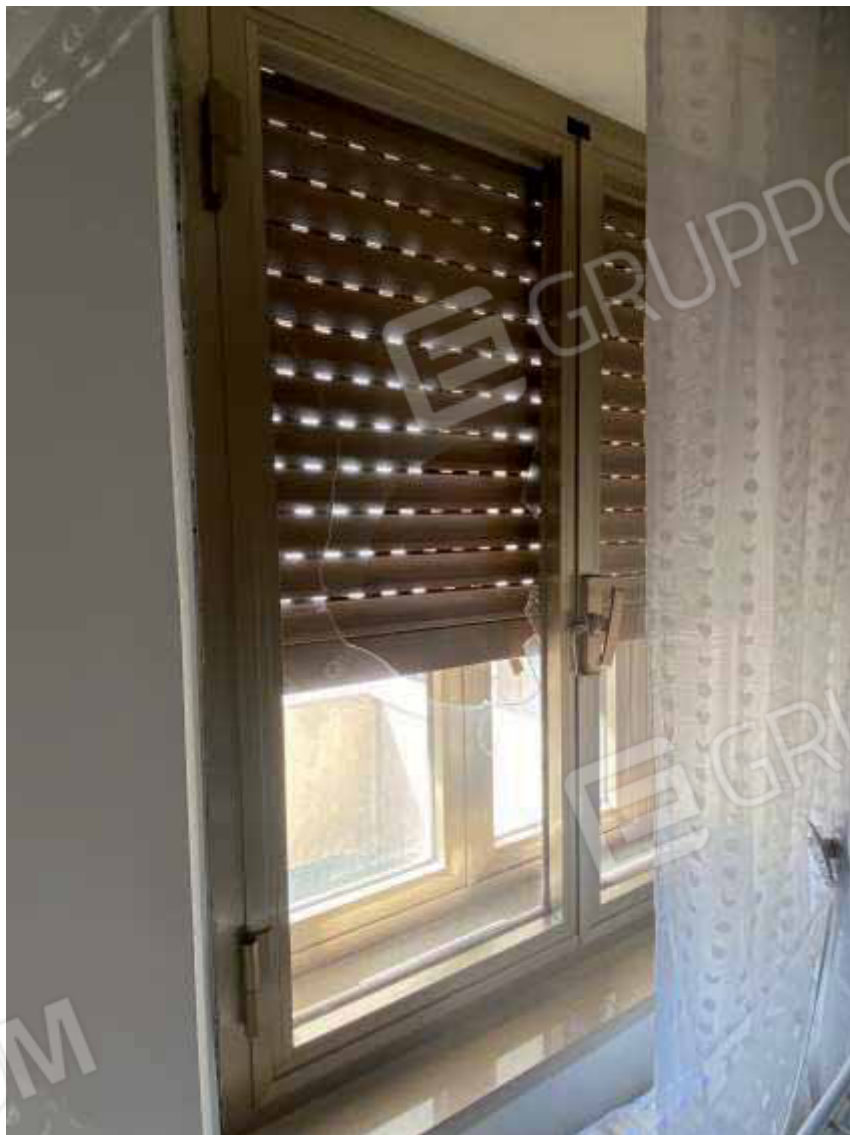
Foto 10) – Vista finestra soggiorno con vetro rotto ( IMMOBILE A )
