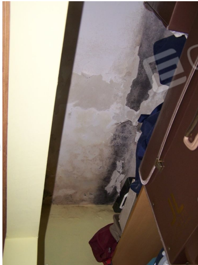
Foto n. 8: Particolare danni da infiltrazione zona ripostiglio immobile S. Severo NCEU F31 P.IIa 10556 sub 3
