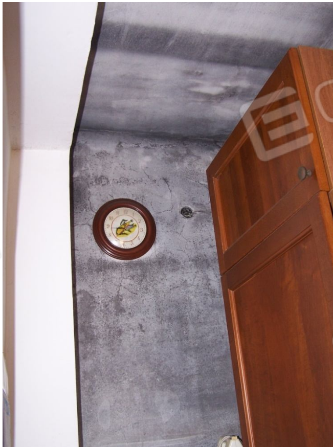
Foto n. 10: Danni da infiltrazioni cucinino immobile via Croghan 32 S. Severo NCEU F31 P.Ila 10556 sub 3
