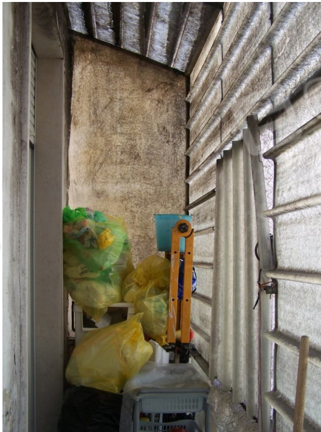
Foto n. 16: Balconcino camera immobile via Croghan 32 S. Severo NCEU F31 P.IIa 10556 sub 3
