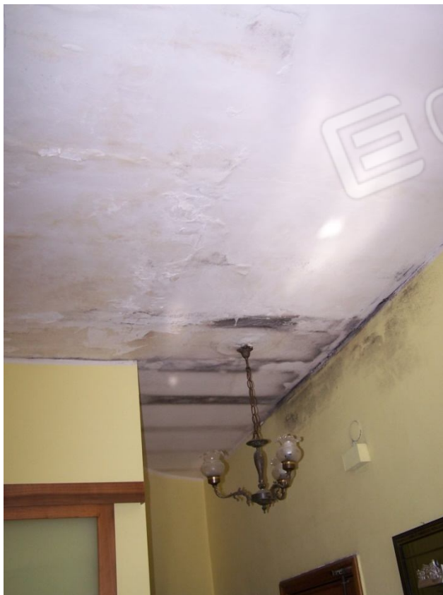
Foto n. 6: Particolare danni da infiltrazioni nell'ingresso -soggiorno immobile via Croghan 32 S Severo NCEU F31 P.IIa 10556 sub 3
