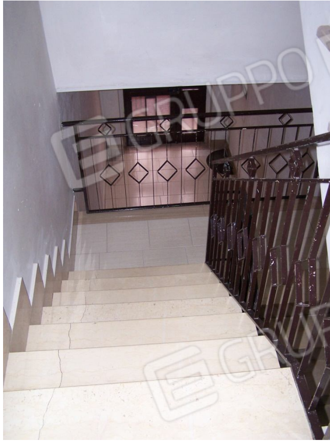
Foto n. 3: Vano scala immobile via Croghan 32 San Severo NCEU F31 P.Ila 10556 sub 3
