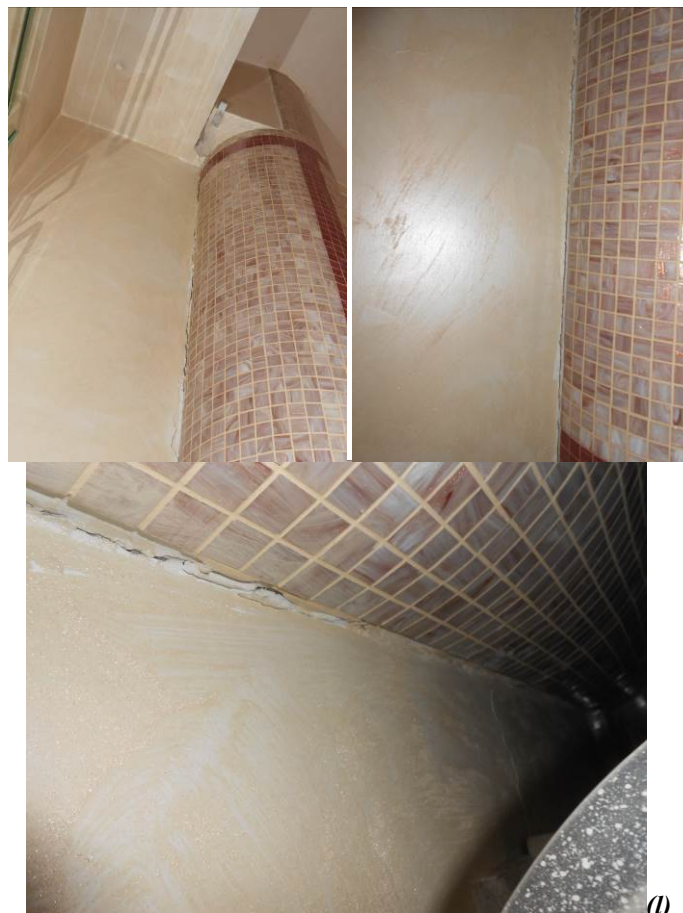
Figura n° 5. Fotografie del quadro fessurativo rilevato sul muro di confine: vano scala delimitato dal muro (a); nicchia (b); lesione 1 (c); lesioni 2-3 e dettaglio dei tratti più larghi (d); lesioni 4-5-6-7-8 e dettaglio dei tratti più larghi (e); lesione 9 e dettaglio del distacco (f); discontinuità muraria 10 (g); discontinuità muraria 11 (h); discontinuità muraria 12 (i); distacco della colonna-pilastro 13 (l).
