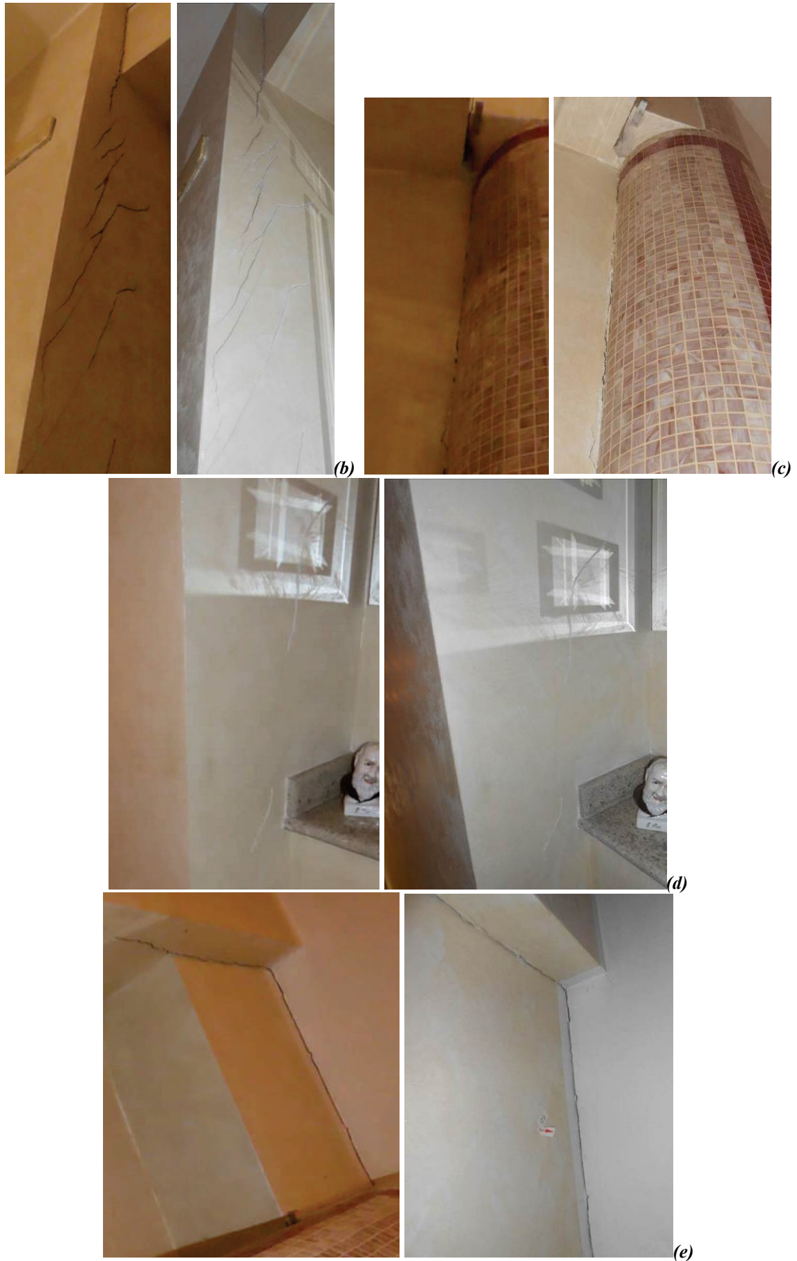
Figura n° 6. Confronto dei rilievi fotografici del quadro fessurativo effettuati nel mese di
