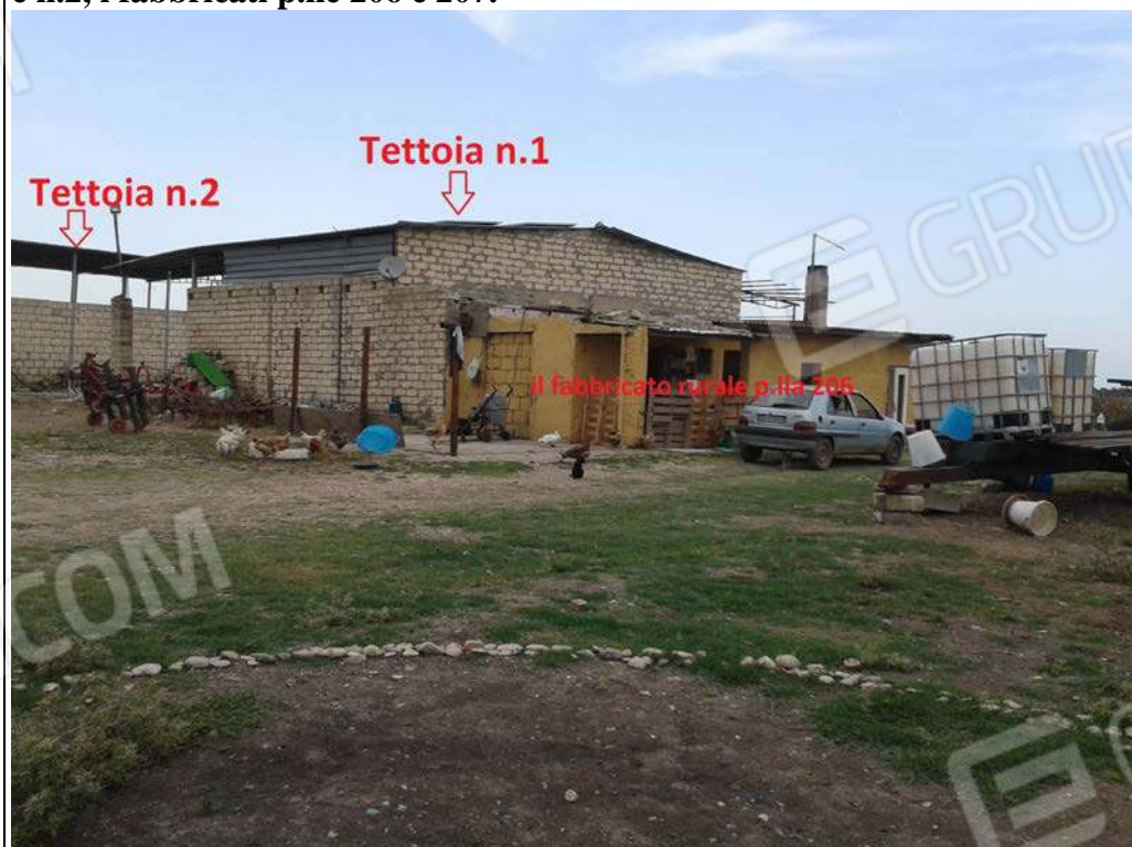
Foto n.44: sull’area adibita a corte, in evidenza i manufatti costituiti dalle tettoie n.1 e n.2, il fabbricato rurale p.lla 206, da notare la precarietà delle tettoie e dei manufatti murari slegati dalle strutture metalliche.
