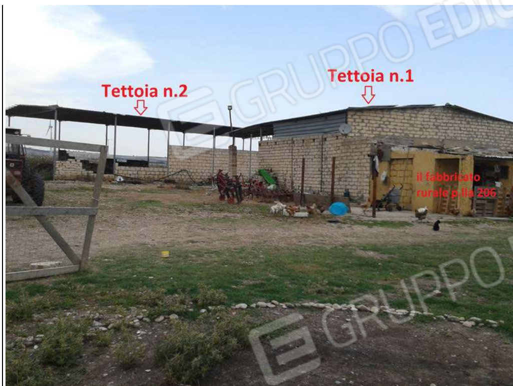
Foto n.45: sull'area adibita a corte, in evidenza i manufatti costituiti dalle tettoie n.1 e n.2, il fabbricato rurale p.lla 206, da notare la precarietà delle tettoie e dei manufatti murari slegati dalle strutture metalliche.
