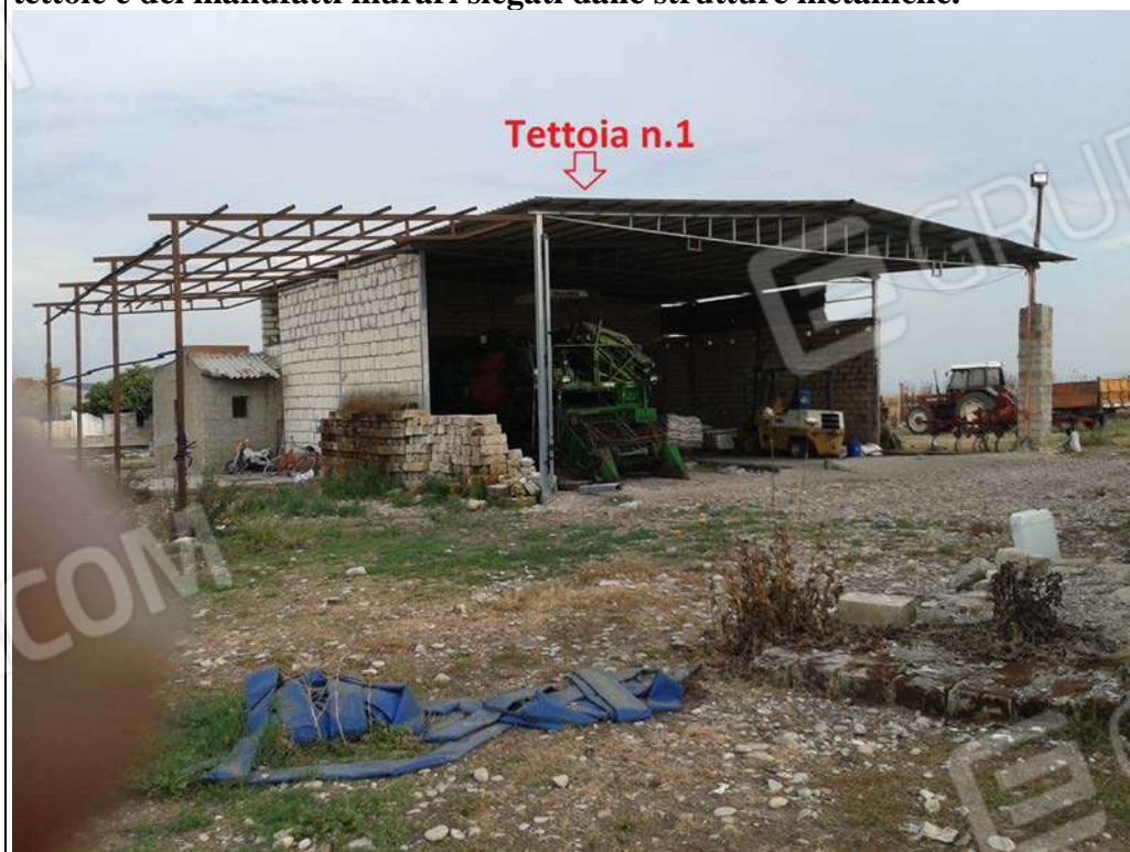
Foto n.46: sull'area adibita a corte, in evidenza i manufatti costituiti dalla tettoia n.1, parte del fabbricato rurale p.lla 206, da notare la precarietà delle tettoie e dei manufatti murari slegati dalle strutture metalliche.
