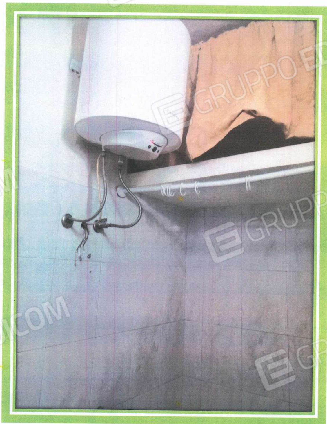
FOTO 11 BOILER NEL VANO BAGNO
