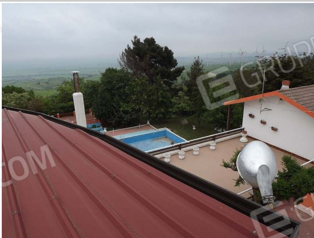
Copertura abusiva in pannelli accoppiati di colore rosso posta sulla sala ricev.
