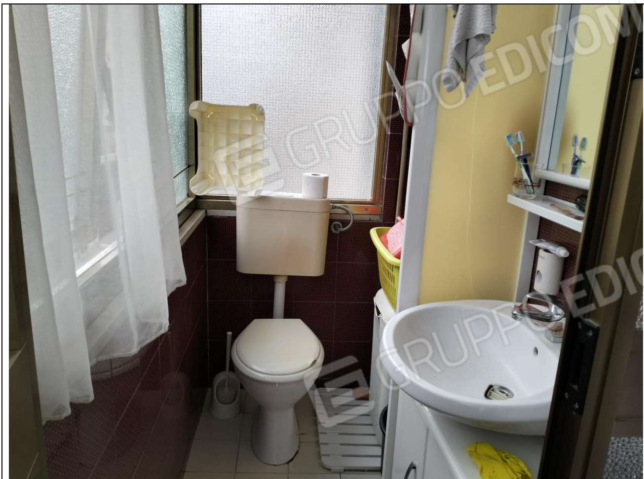
23 – Appartamento in primo piano: abuso edilizio non sanabile che consiste nella realizzazione del w.c. in primo piano, sul balcone, uscendo a destra, dalla cucina, che andrà smontato
