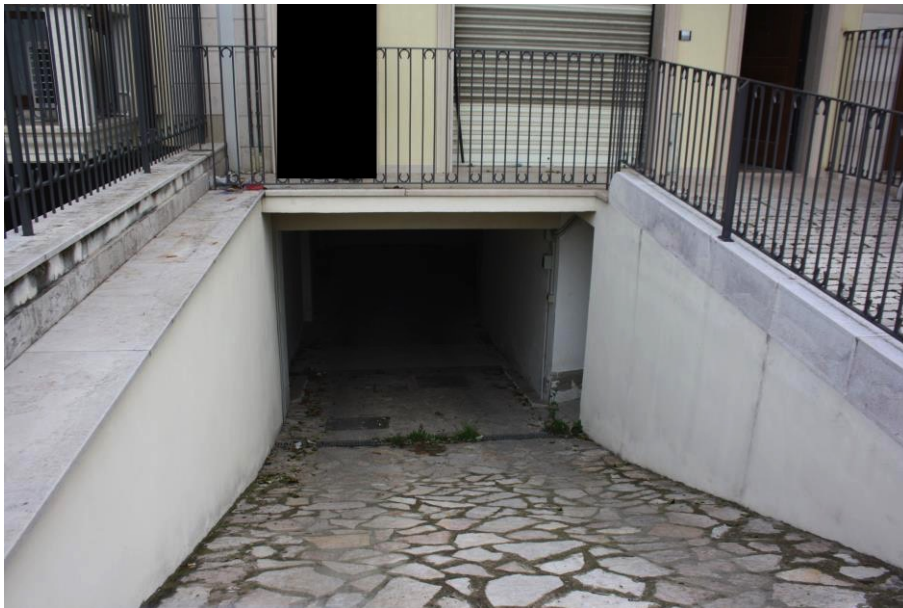
Rampa di discesa al locale deposito al grezzo che si trova al piano interrato
