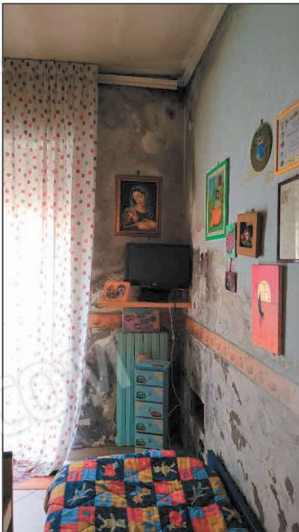
Foto 11 – Ammaloramento infiltrazioni cameretta.
