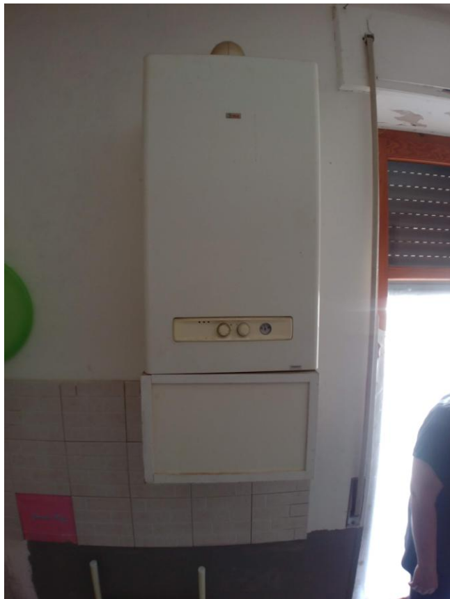
Figura 12: piano primo (caldaia murale a gas)
