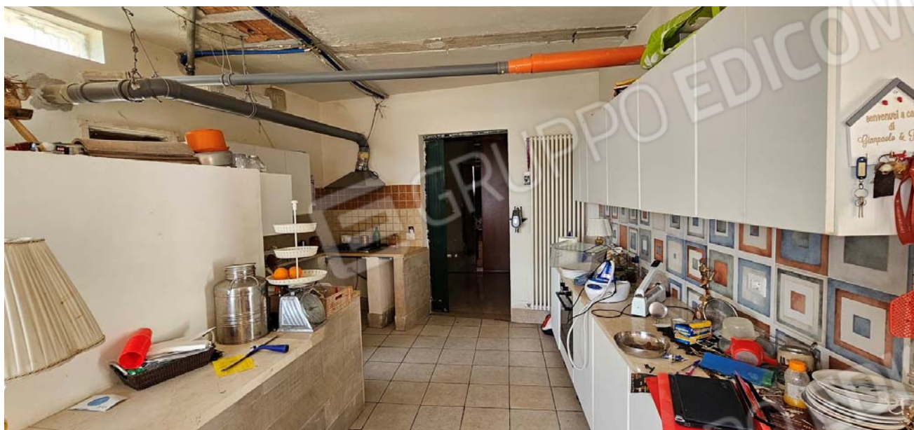
Vano difforme: alloggio, piano terra
