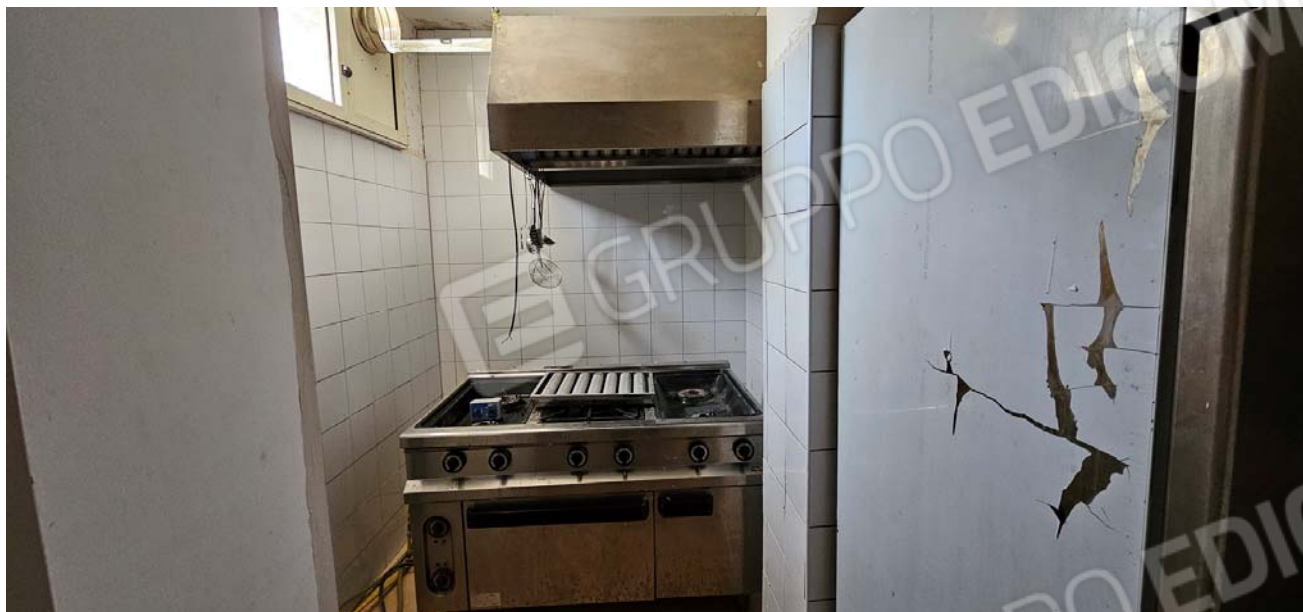
Vano difforme: cucina piano primo
