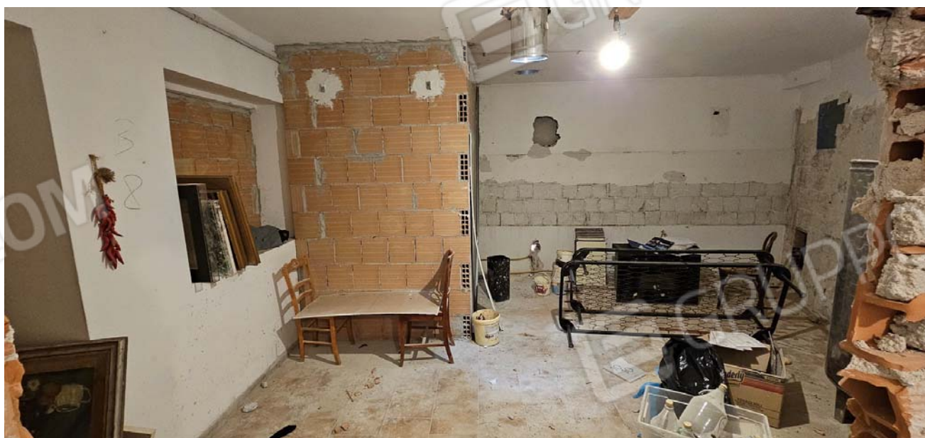
Vano difforme: magazzino piano primo
