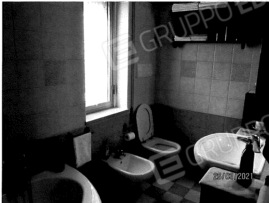
FOTO N. 13 – BAGNO – ARTICOLI SANITARI.
