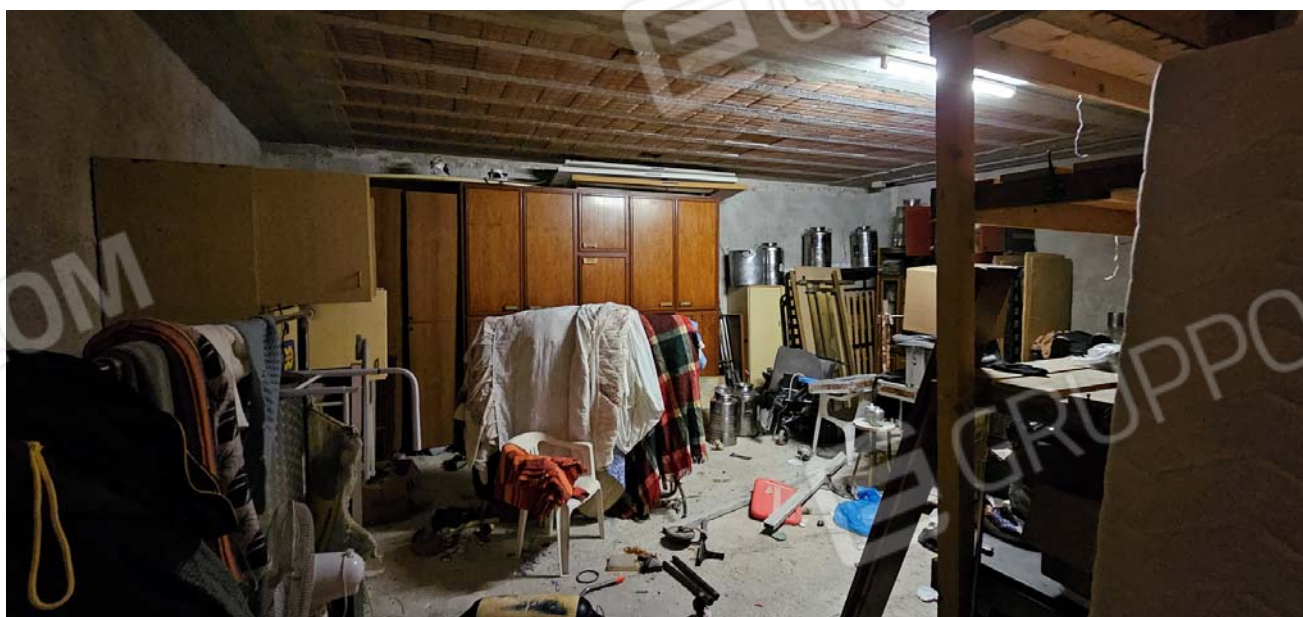
Vano difforme: deposito piano terra
