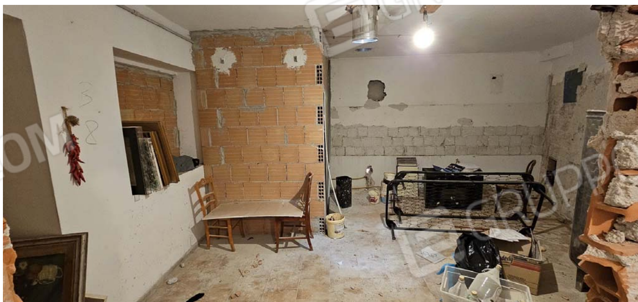
Vano difforme: magazzino piano primo
