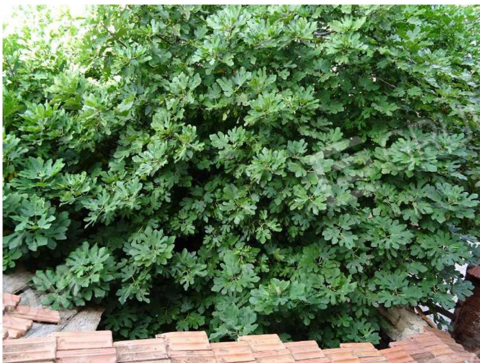
Foto n. 18 Particolare Vegetazione arborea cresciuta interno immobile p.lla 2484
