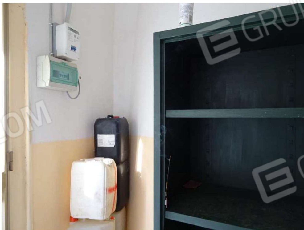
Foto n. 12 Zona ingresso – impianto elettrico
