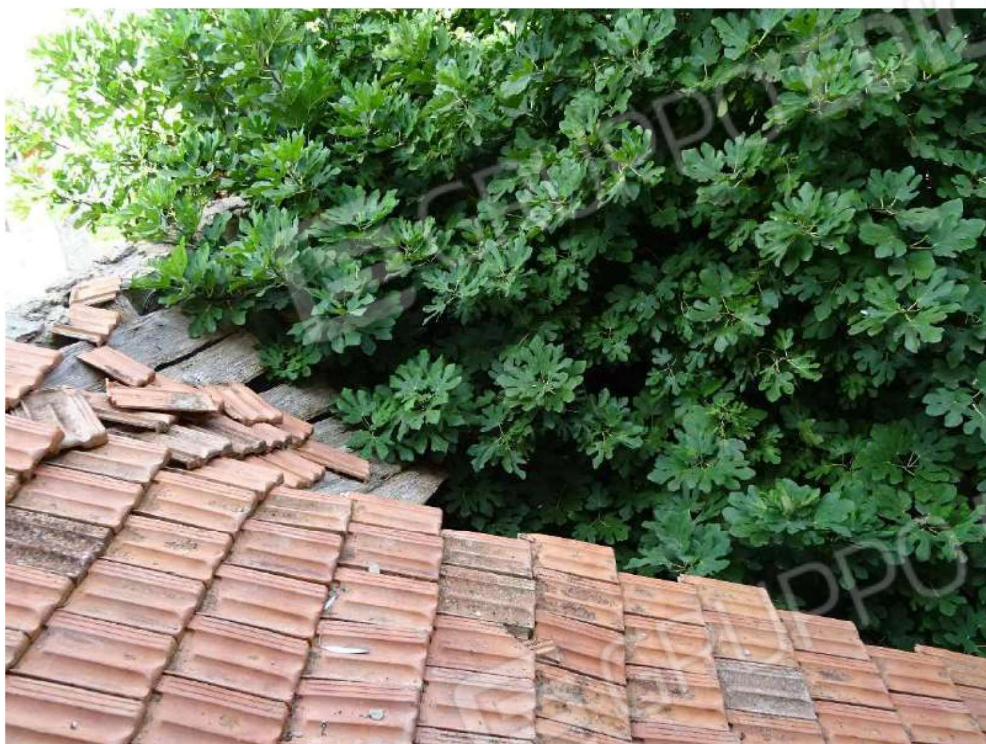
Foto n. 17 Particolare copertura con tetto crollato
