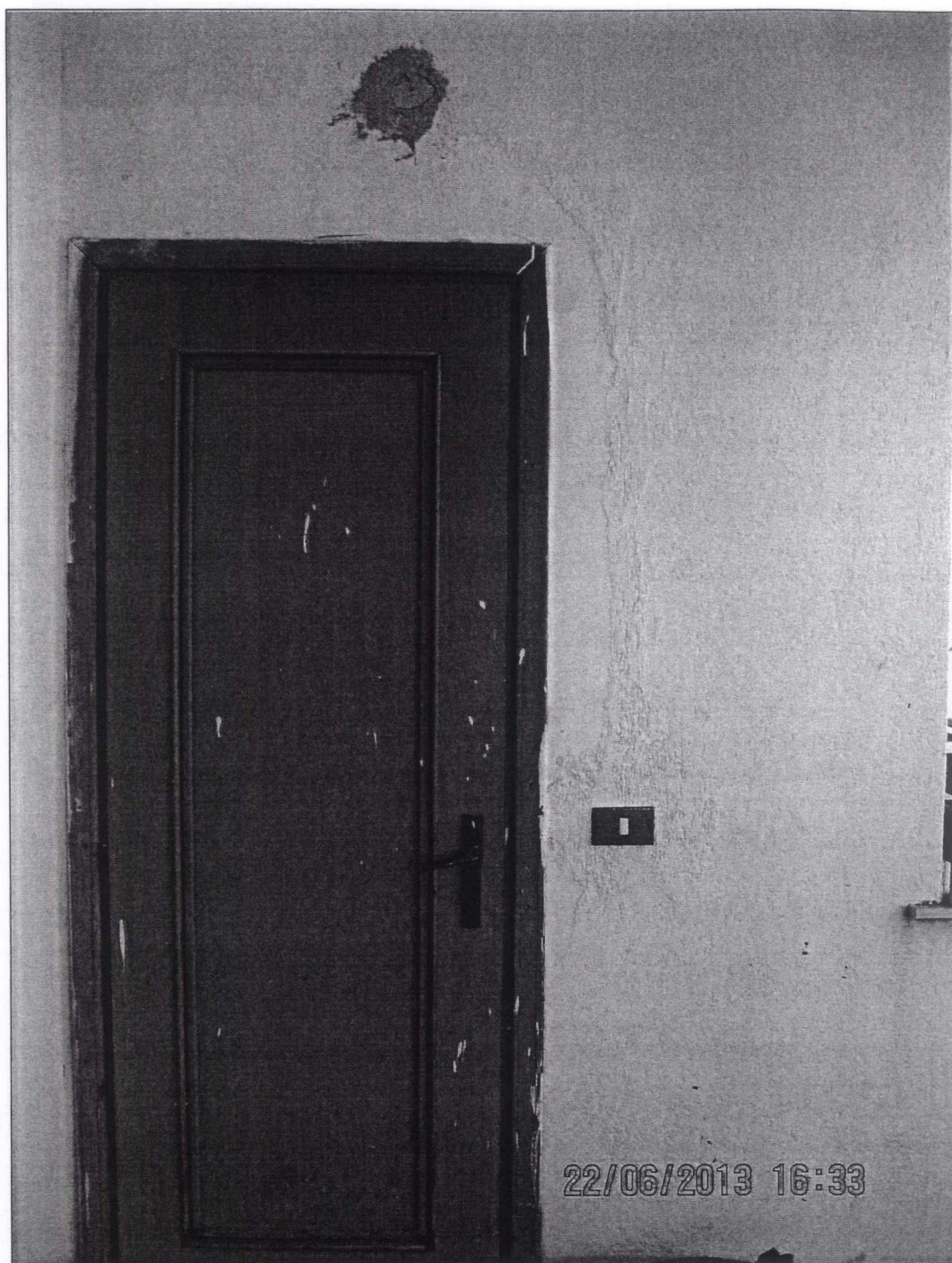
FOTO 13 - Porta del vano tecnico situato sul balcone.
