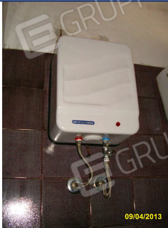
25 - Interno proprietà [redacted] : boiler elettrico
