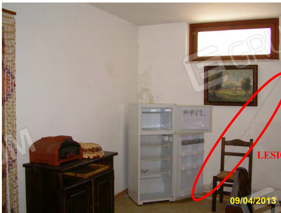
8 - Particolare zona giorno (2), lesioni
