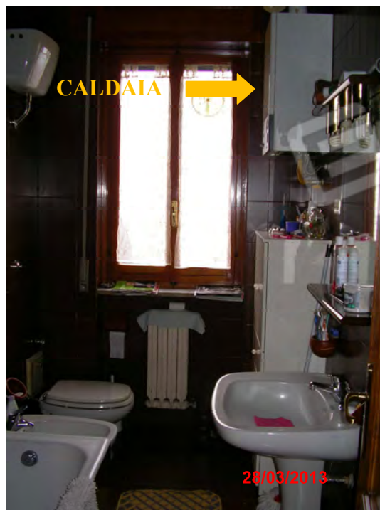
12 - Interno proprietà [REDACTED]: caldaia (1)
