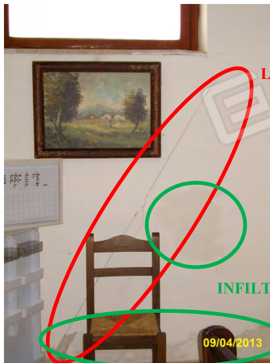
22 - Interno proprietà [REDACTED]: lesioni, infiltrazioni
