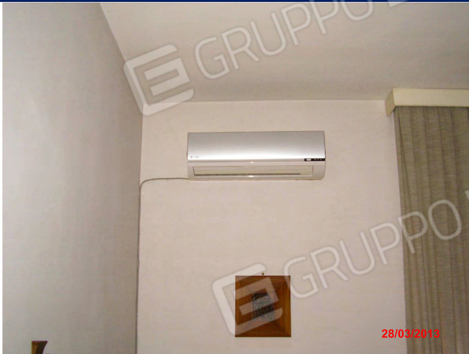
15 - Interno proprietà [REDACTED]: condizionatore
