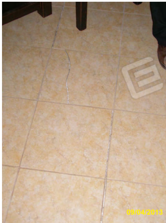
18 - Interno proprietà [redacted]: pavimento, lesioni
