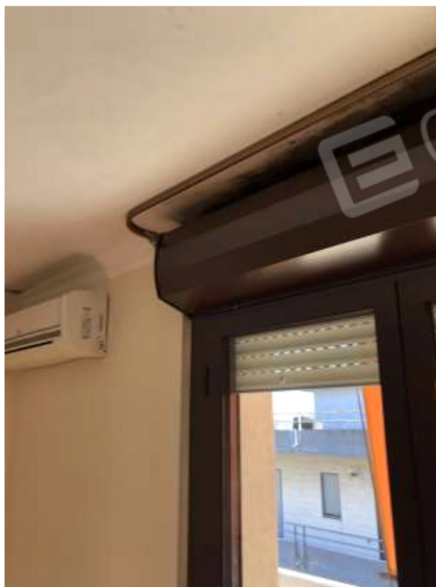
Foto 12: particolare infiltrazioni camera da letto 1
