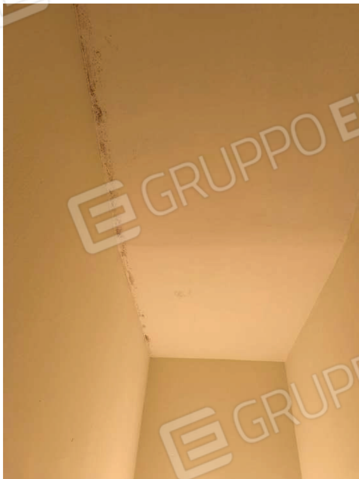
Foto n.11 (Zona solaio piano terzo)
