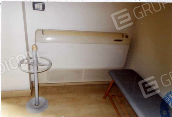
FOTO N. 10 – PARTICOLARE CONDIZIONATORE A PARETE
