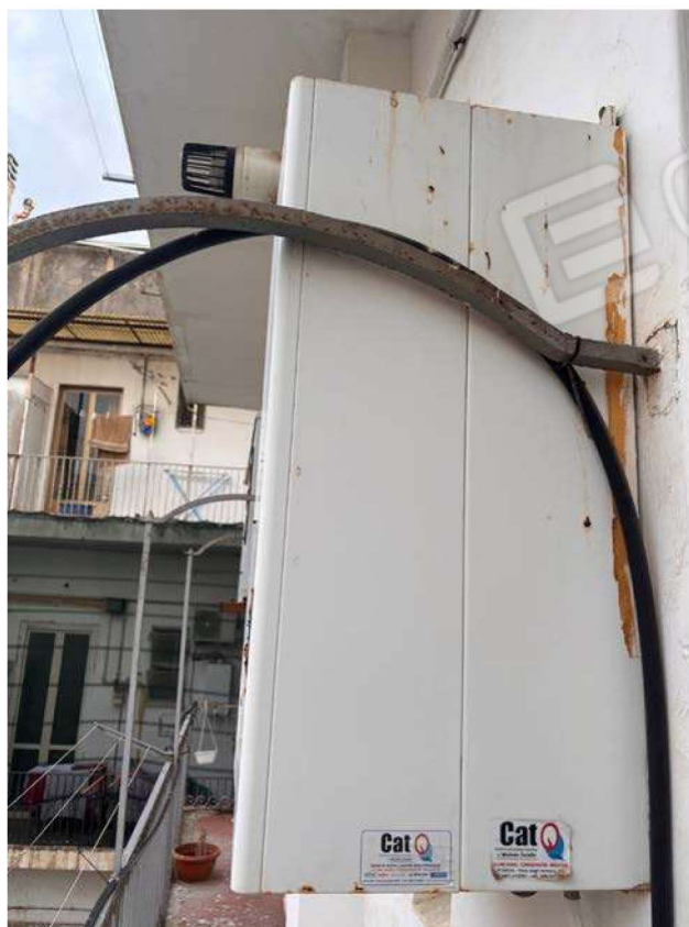
Foto 22: particolare alloggiamento caldaia
