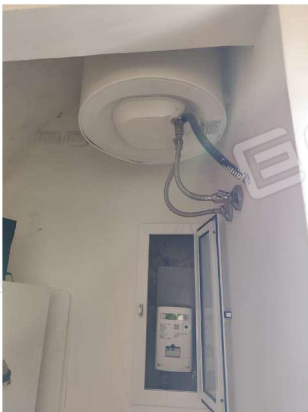
FOTO N. 9 – PARTICOLARE BOYLER ELETTRICO
