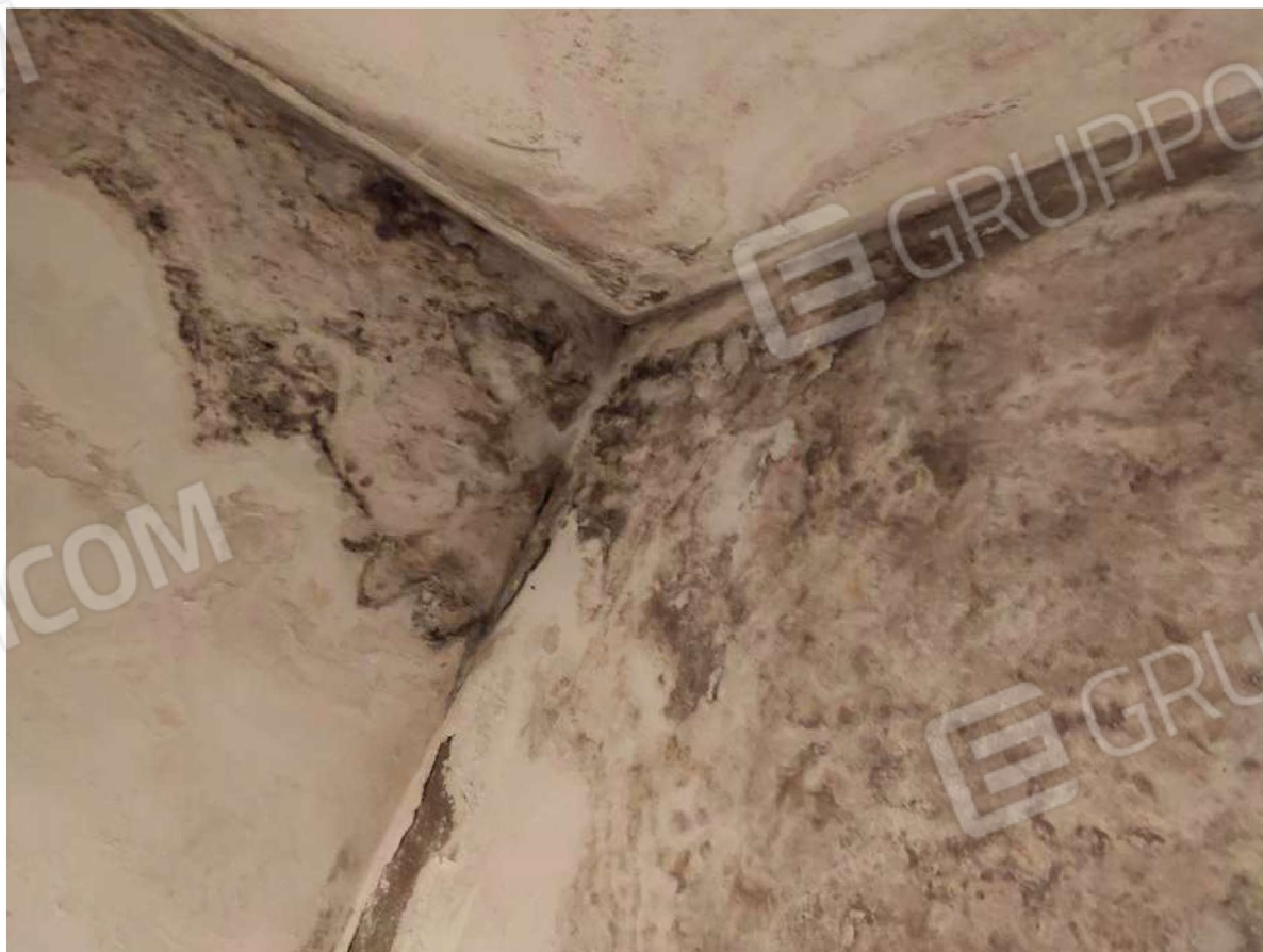
Sub. 4 – Muffe ed efflorescenze nel vano scala che conduce al piano secondo [Foto 18]
