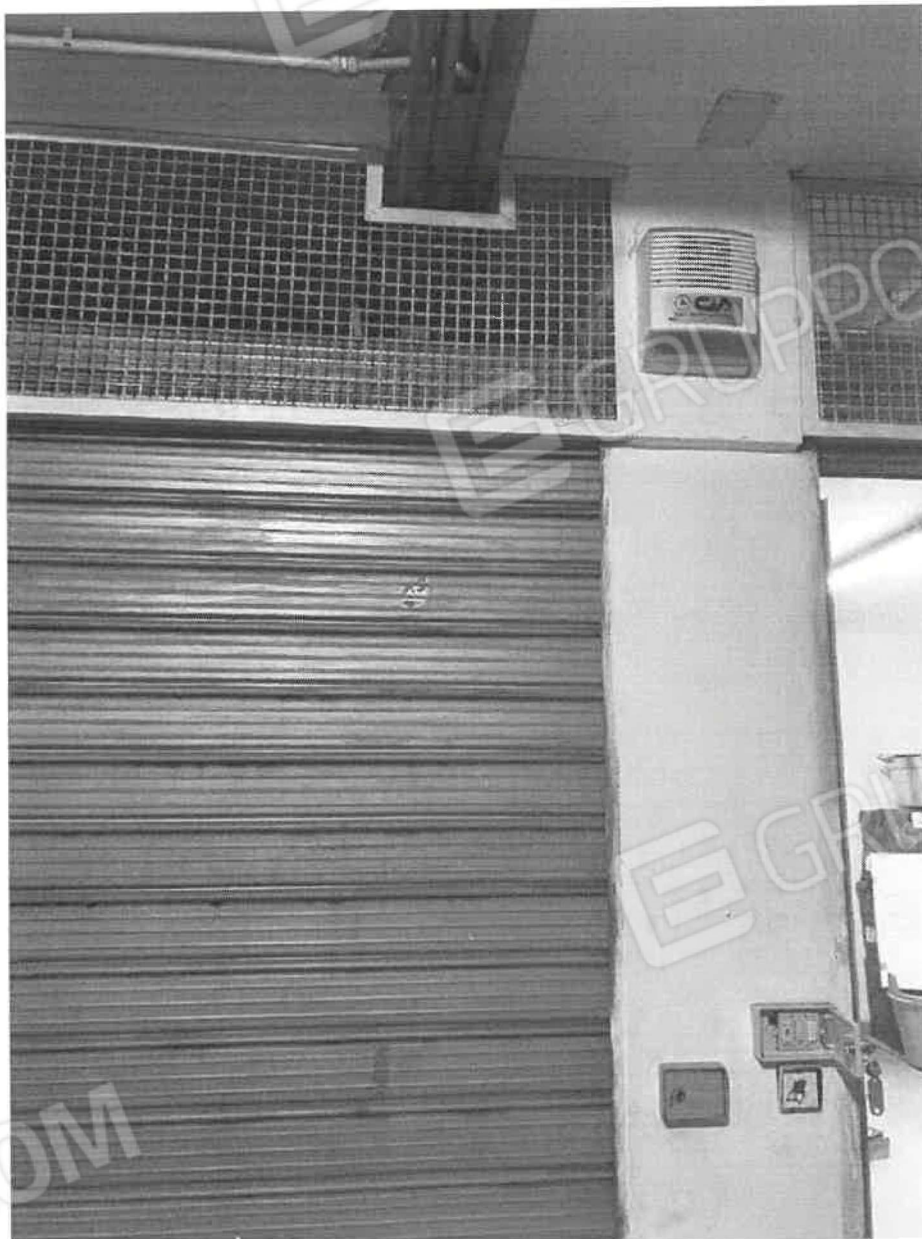
FOTO n. 5 – Particolare sistema di allarme box –
