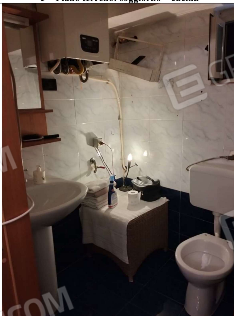
6 – Piano terreno: bagno abusivo da sanare
