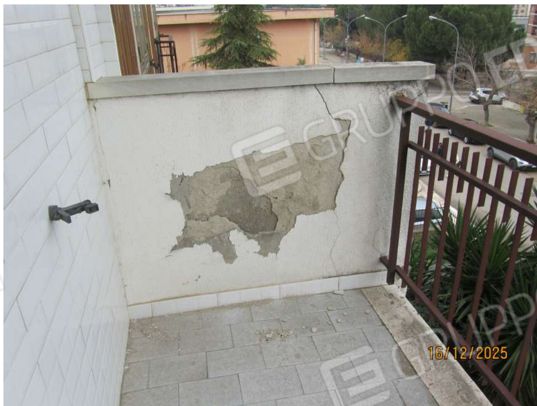
FOTO N. 15 – PARTICOLARE STATO MANUTENZIONE VELETTA BALCONE
