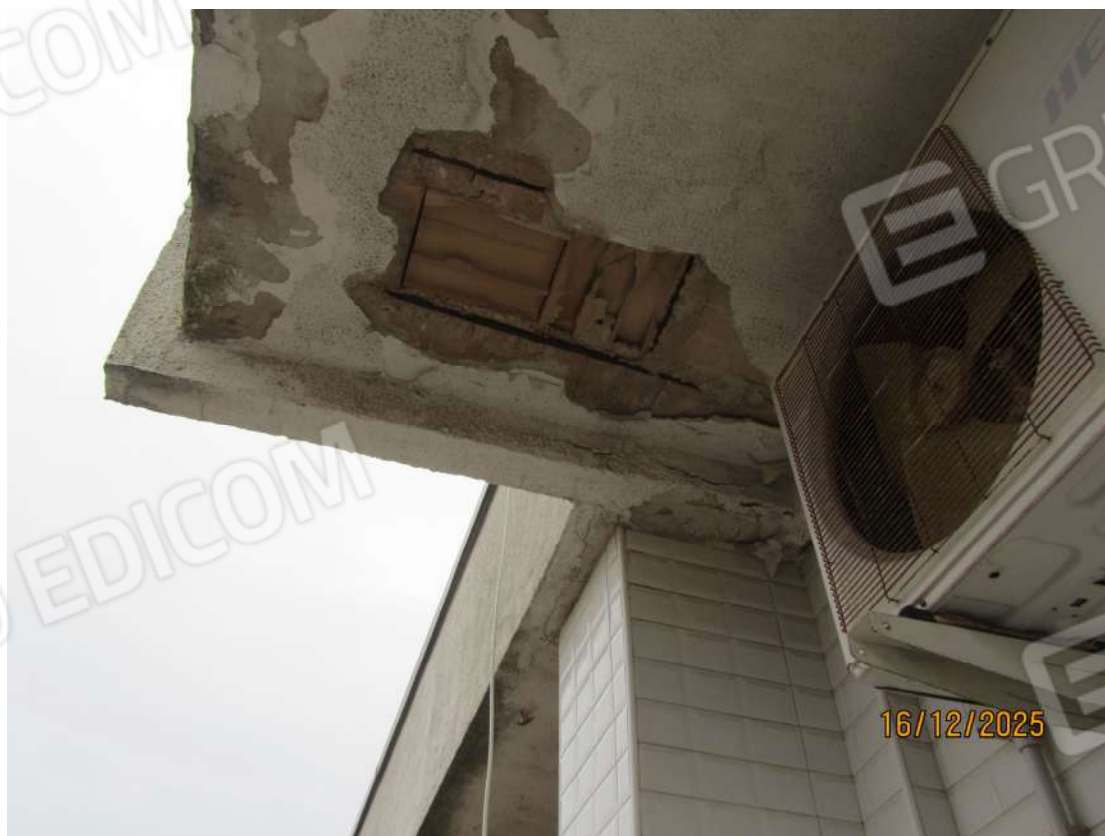
FOTO N. 16 – PARTICOLARE SOTTOCIELO BALCONE – STATO MANUTENZIONE
