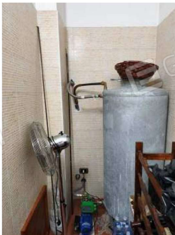
Foto n.26 (Locale tecnico piano seminterrato)
