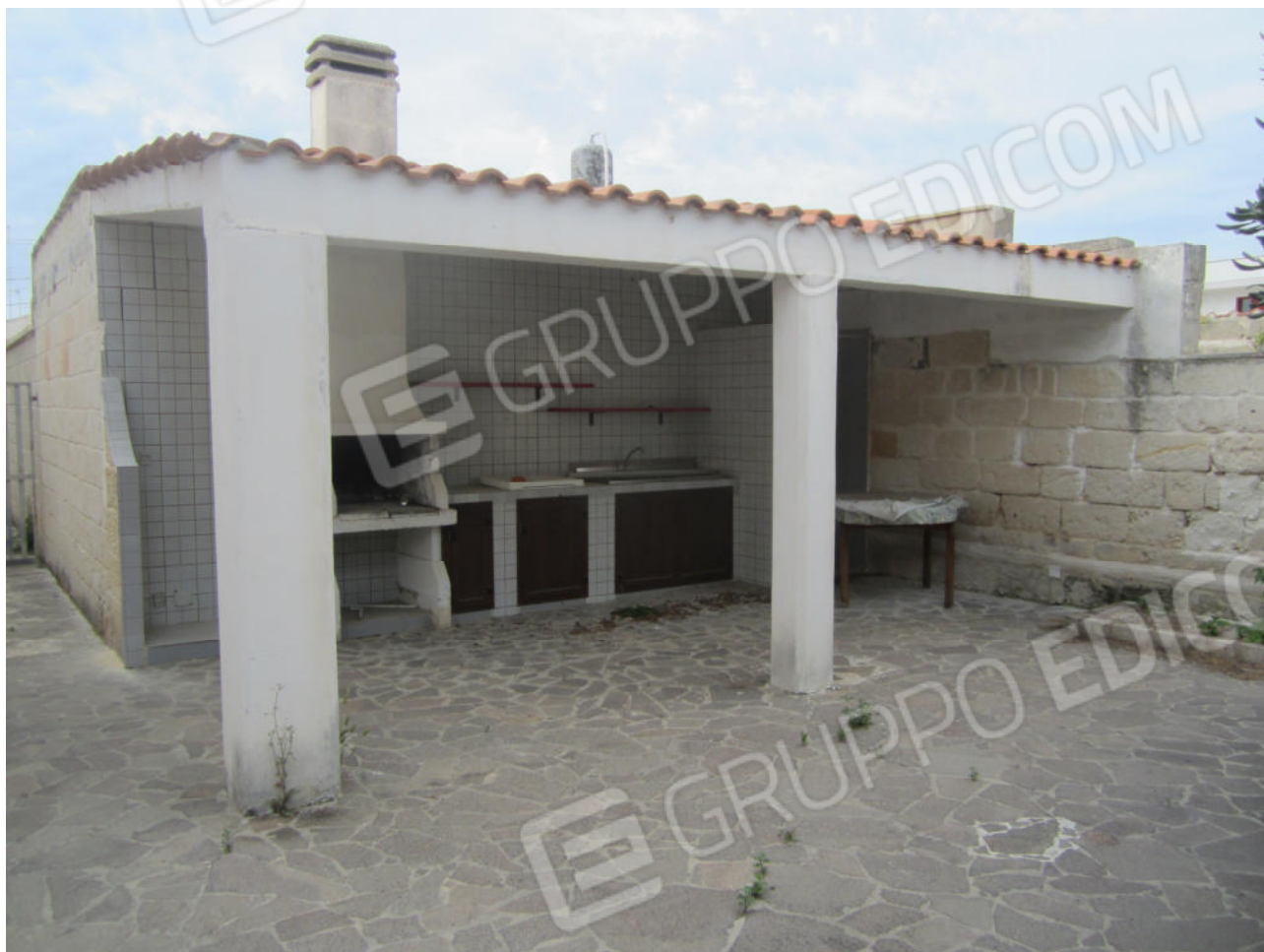
Foto n. 15 – tettoia priva di autorizzazione urbanistica
