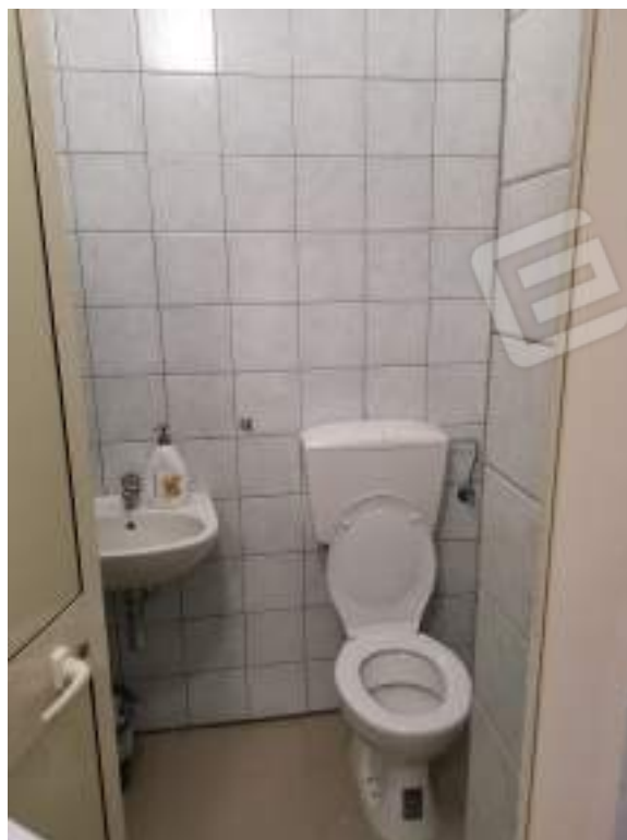
Figura 13: Wc Piano Interrato
