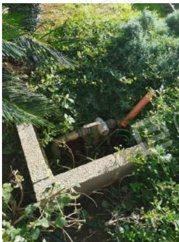
Figura 21: Pozzo Artesiano presente nella struttura
