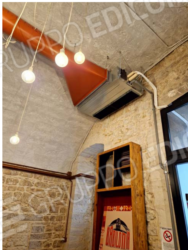
macchina di condizionamento
