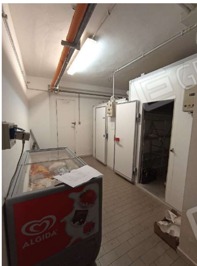
Foto 104 – Zona Celle Frigo
