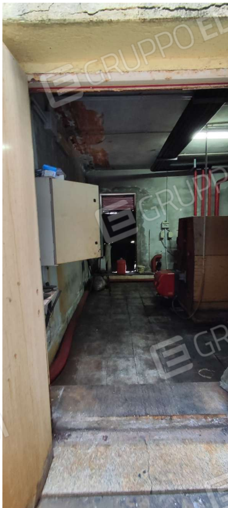
Foto 111 – Ingresso Centrale Termica
