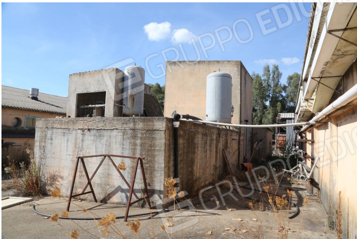
104 – VASCA RISERVA IDRICA E LOCALE POMPE (Particella 197)
