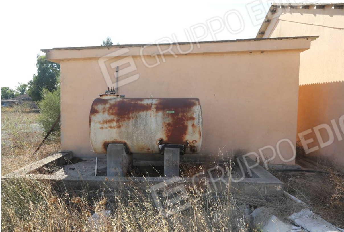
90 – CENTRALE TERMICA 1 (Particella 199)
