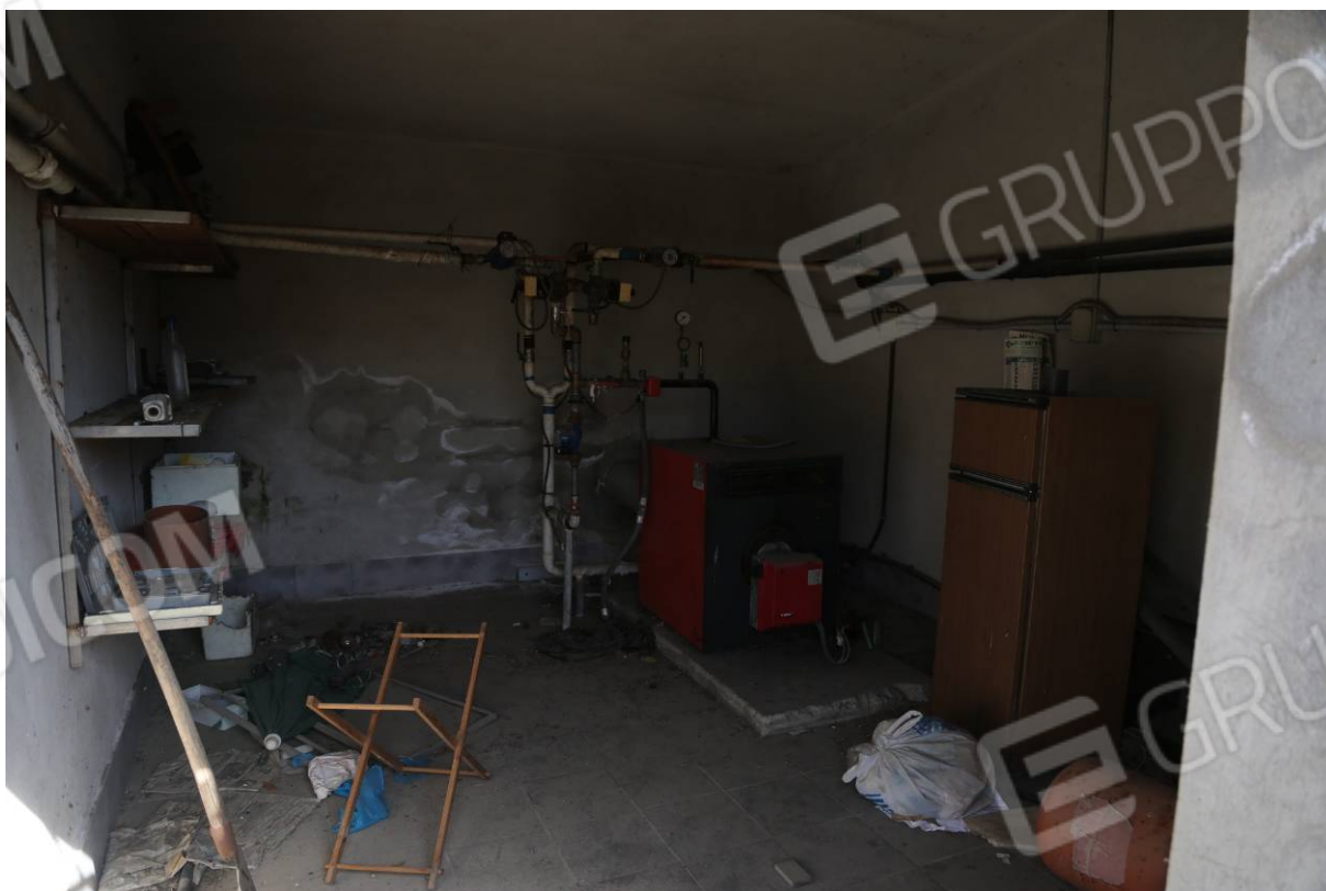
76 – BOX INGRASSO – Interno centrale Termica – (Particella 156)
