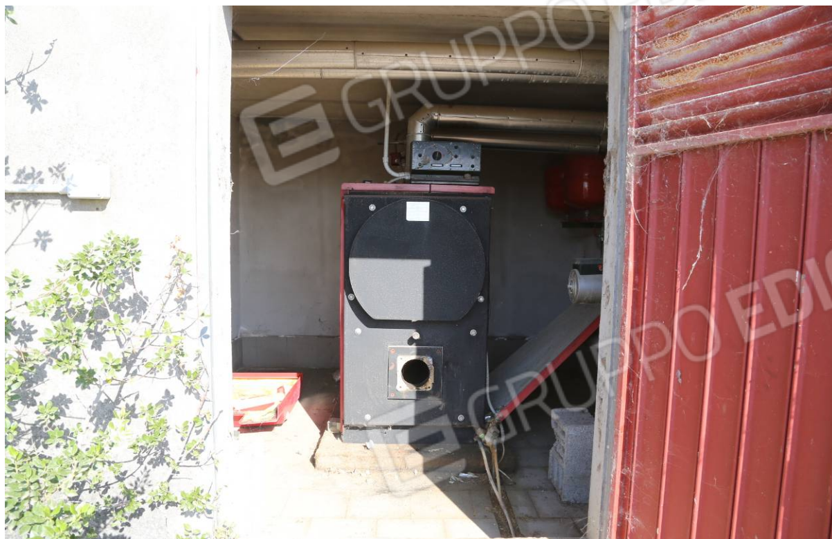
94 – CENTRALE TERMICA 4 (Particella 204)
