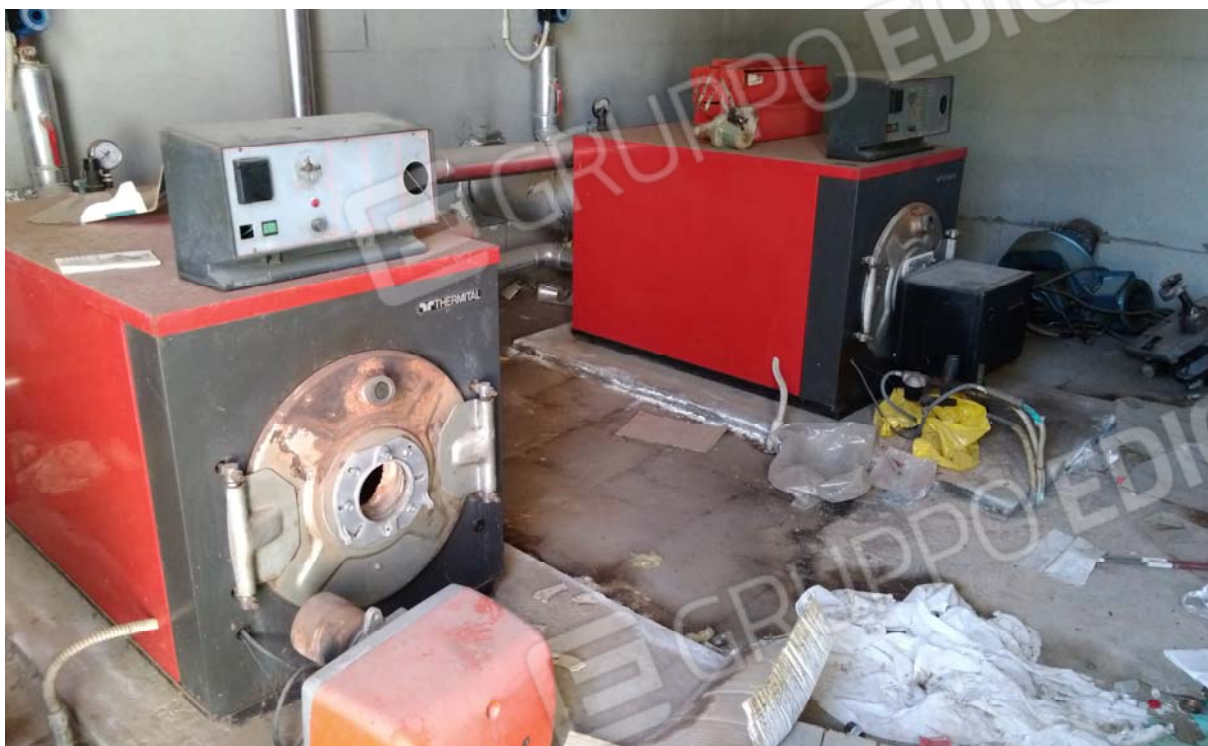
92 – CENTRALE TERMICA 2 (Particella 200) – Interno
