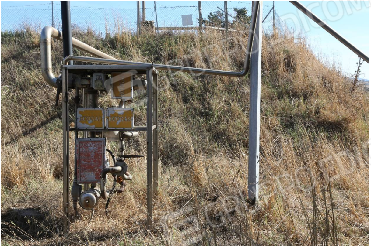
110 – IMPIANTO BIO GAS: Apparecchiature
