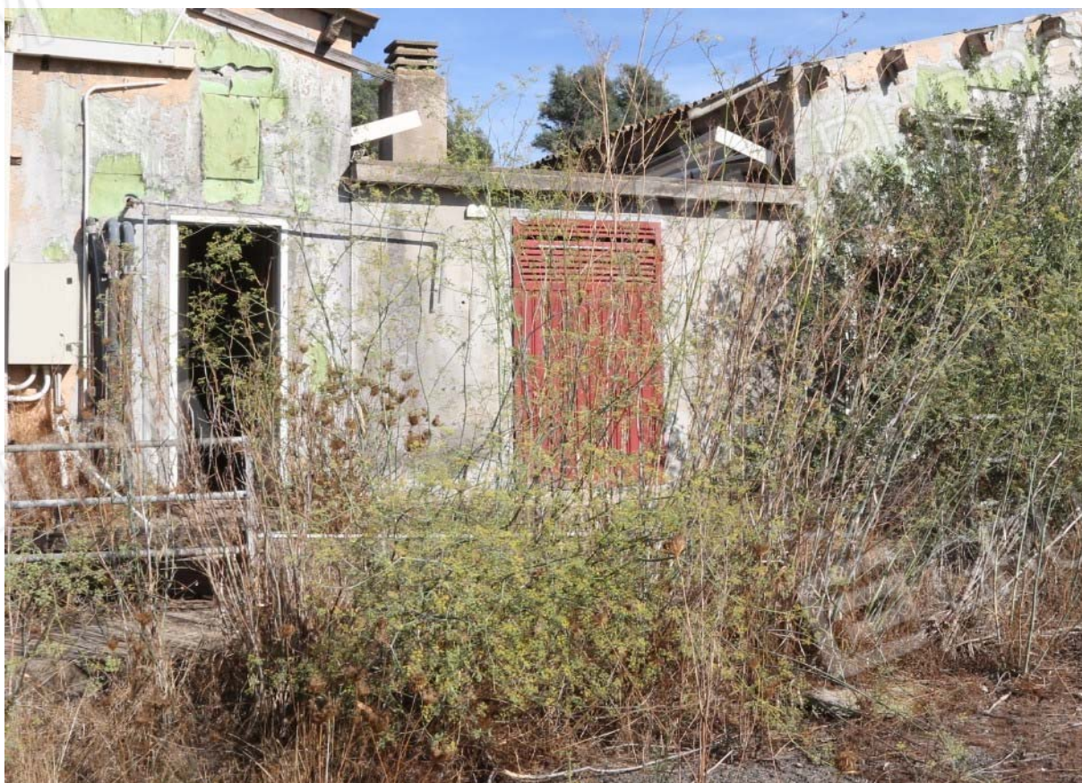
93 – CENTRALE TERMICA 3 (Particella 203)
